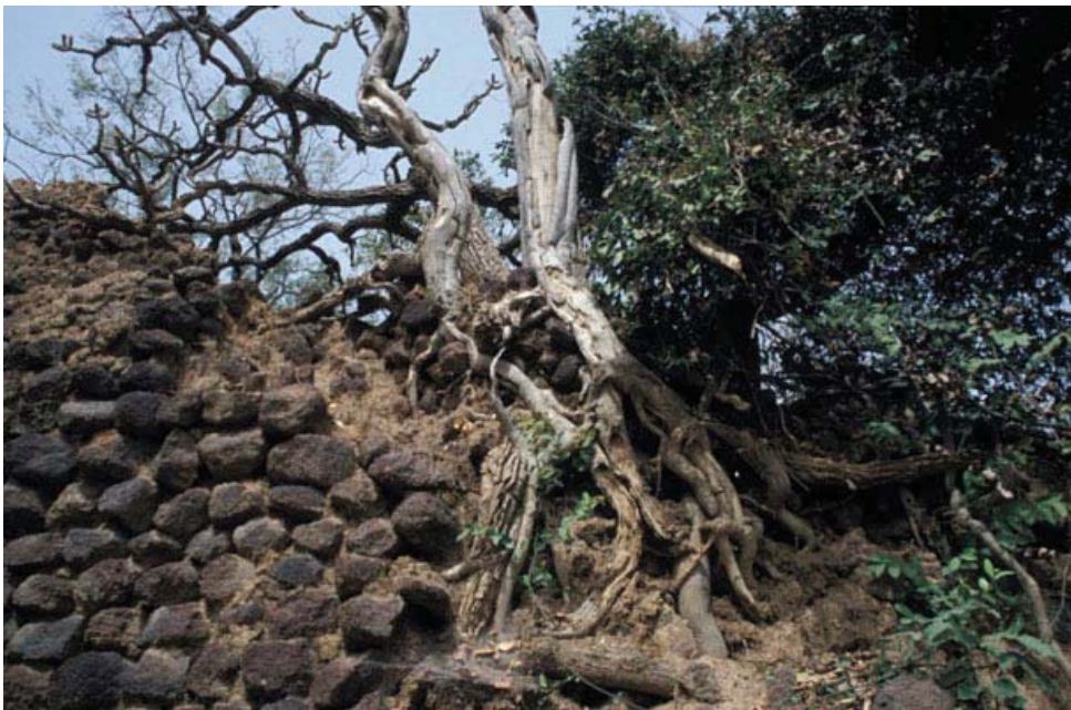
Les structures de pierres détruites par la végétation
