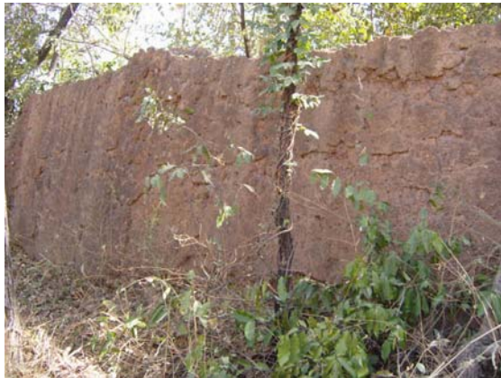
Photo n° 53 : Ruine de Bini mur crépi
