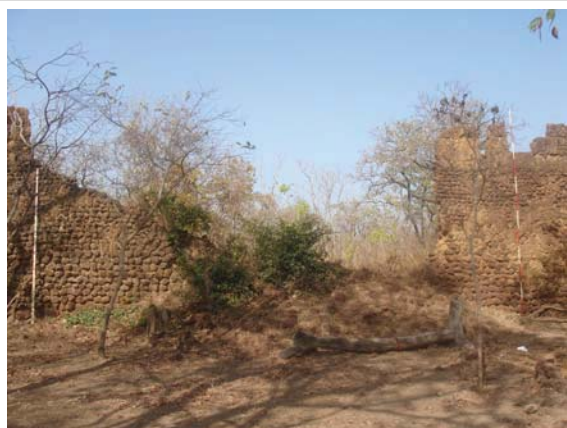
A. Eboulement important du mur d'enceinte à l'Ouest du secteur 7
