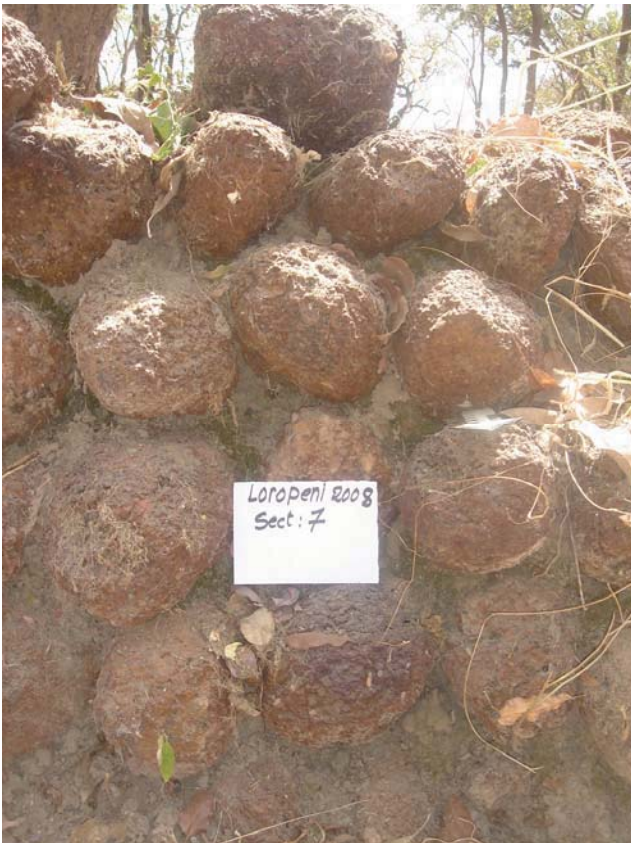
B. Vu de près, on remarque la présence de mortier entre les moellons
