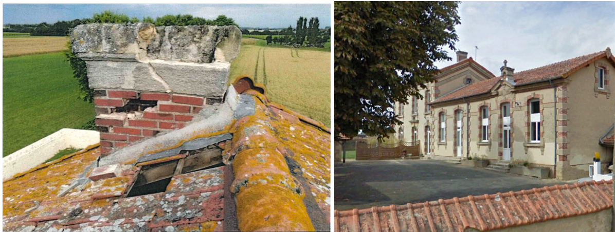
Fig 11. Chute d'élément de maçonnerie d'une cheminée (photo Gauche : ©Bernier, droite : Google Street view 2009).
