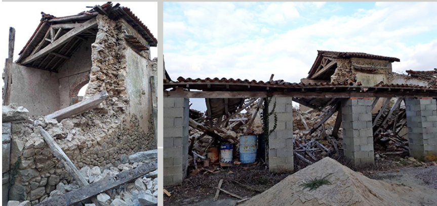
Fig. 8 – Endommagement de degré 4 au lendemain du séisme sur une grange de vulnérabilité A (commune de Chiché – lieu-dit La Lusière).
