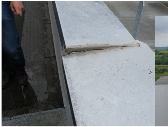
Fig. 44 – Endommagement du joint en silicone.
