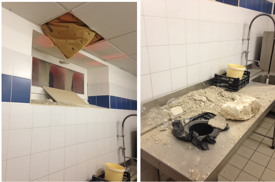
Fig. 18 - Chute d'une pierre du mur du Casino dans la cuisine.
