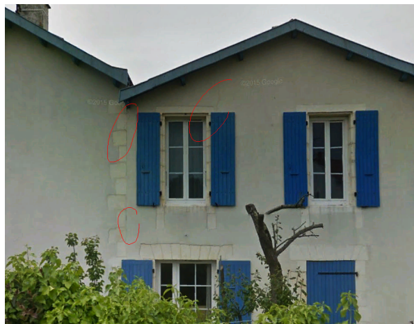
Fig. 10 – Endommagement visible en 2015 sur Angoulins (GoogleStreetView).
