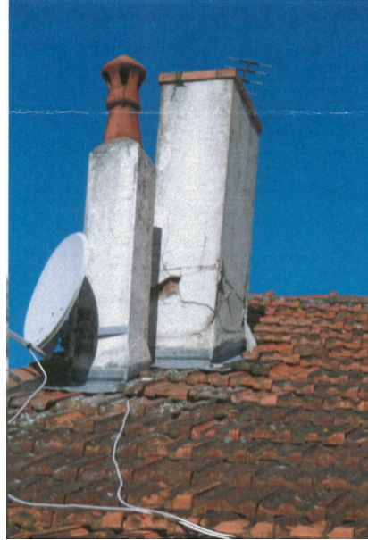
Fig. 31 – Fissuration et éclatement de crépis de cheminée.
