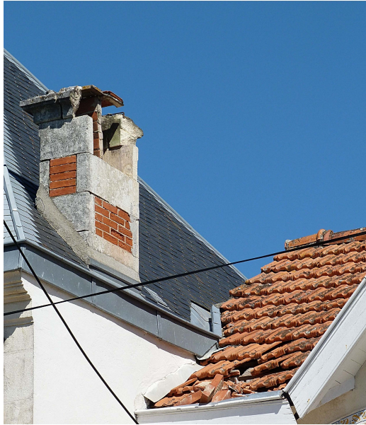
Fig. 30 - Rue Cadoret – Fouras, endommagement partiel de cheminée et de toiture suite à un mouvement E-W.
