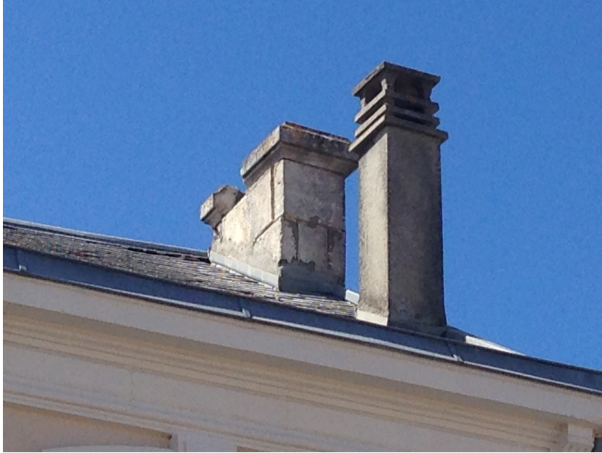
Fig. 15 - Partie de cheminée endommagée rue du marché.
