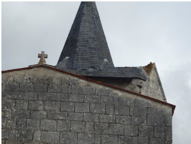
Fig. 32 – Glissement d'Ardoises (église Notre Dame de Salles).
