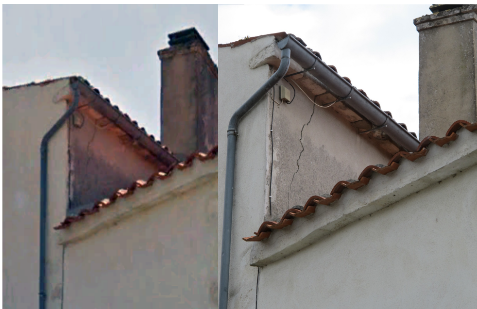
Fig.36 – Fissuration déclarée suite au séisme (image de gauche Google 2013, image de droite 12 mai 2016).
