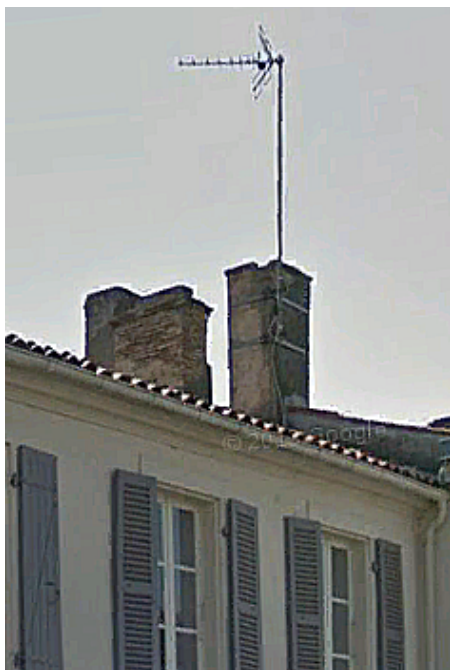
Fig. 41 – Etat de la cheminée (2013).
