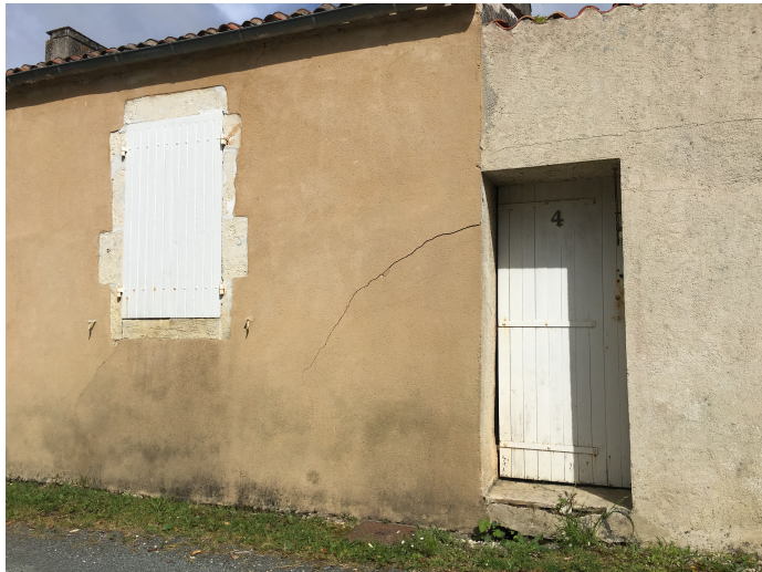
Fig. 40 – Fissuration légère en façade (rue de l'église).
