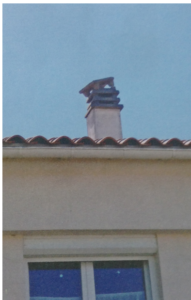
Fig. 21 – Endommagement d'une cheminée (Av. Général de Gaulle, Angoulins).
