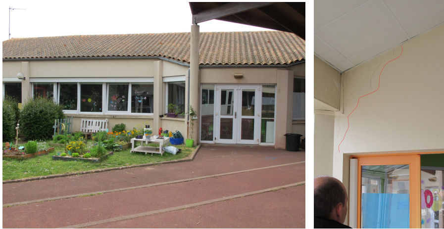
Fig. 26 – Dommage de degré 1 - école maternelle d'Angoulins.
