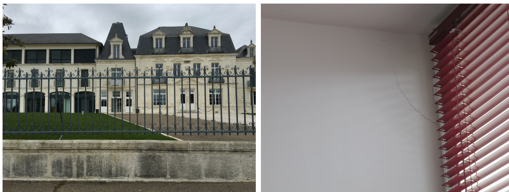
Fig. 19 - Dommages de degré 1 dans le centre culturel Beauséjour.
