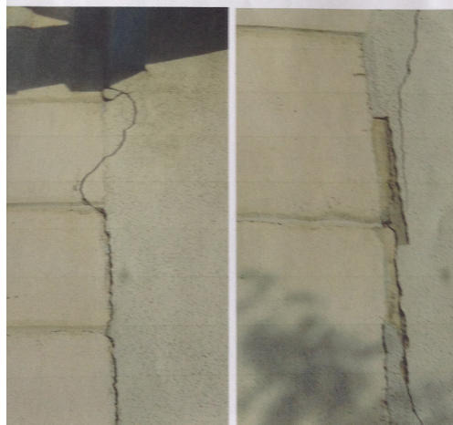
Fig. 11 – Endommagement déclaré après le séisme.
