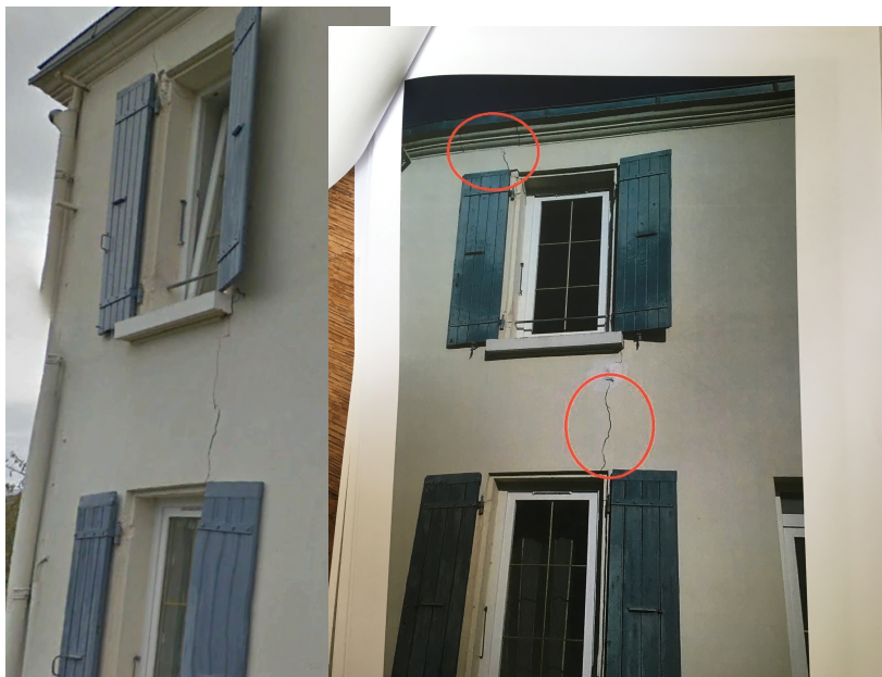
Fig. 43 – Fissuration déclarée suite au séisme (image de gauche Google 2013, image de droite après séisme).
