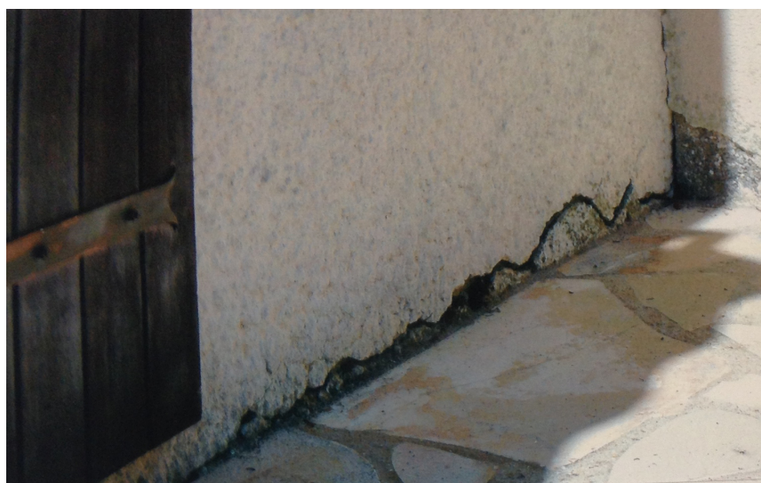
Fig. 12 – Endommagement préexistant sans rapport avec les effets sismiques (Angoulins).
