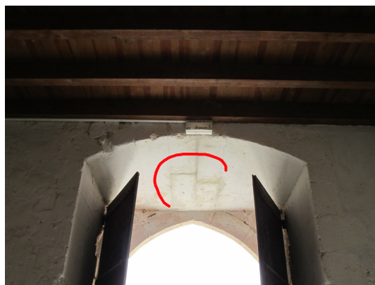
Fig.35 - Chute de la clef de voûte (ici réparée).
