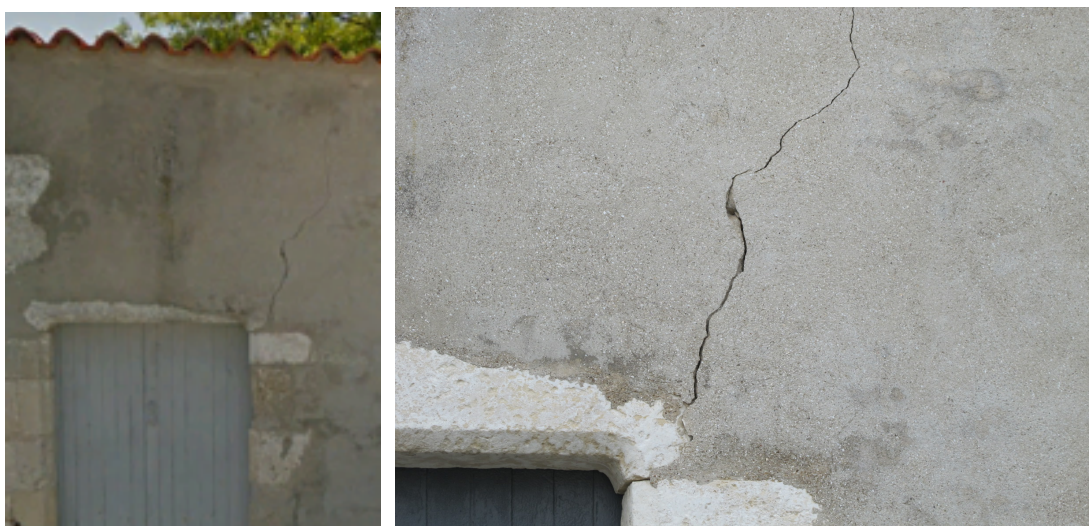
Fig.37 – Fissuration déclarée suite au séisme (image de gauche Google 2013, image de droite 12 mai 2016).
