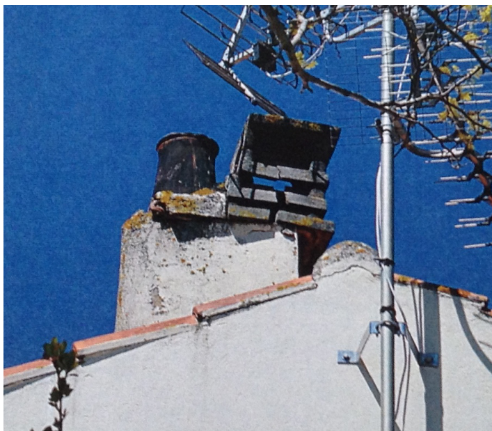
Fig. 22 – Endommagement d'une cheminée (Angoulins).
