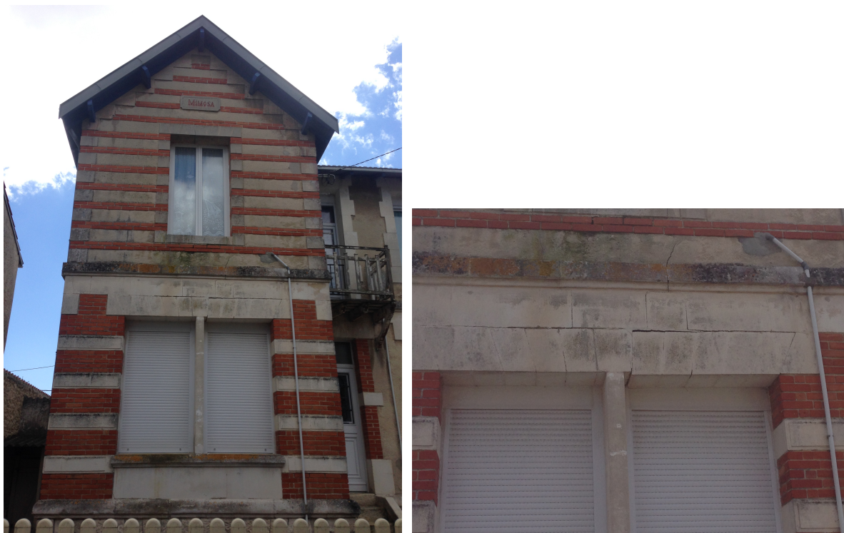
Fig.13 – Détachement de pierre composant le haut d'un encadrement de fenêtre – rue des dunes.
