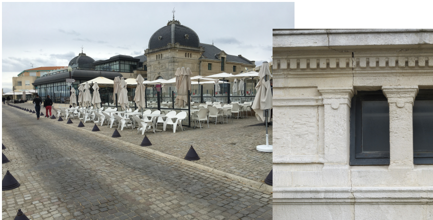
Fig. 16 – Fissure fine de la façade du Casino de Chatelaillon suite à un mouvement principalement E-W
