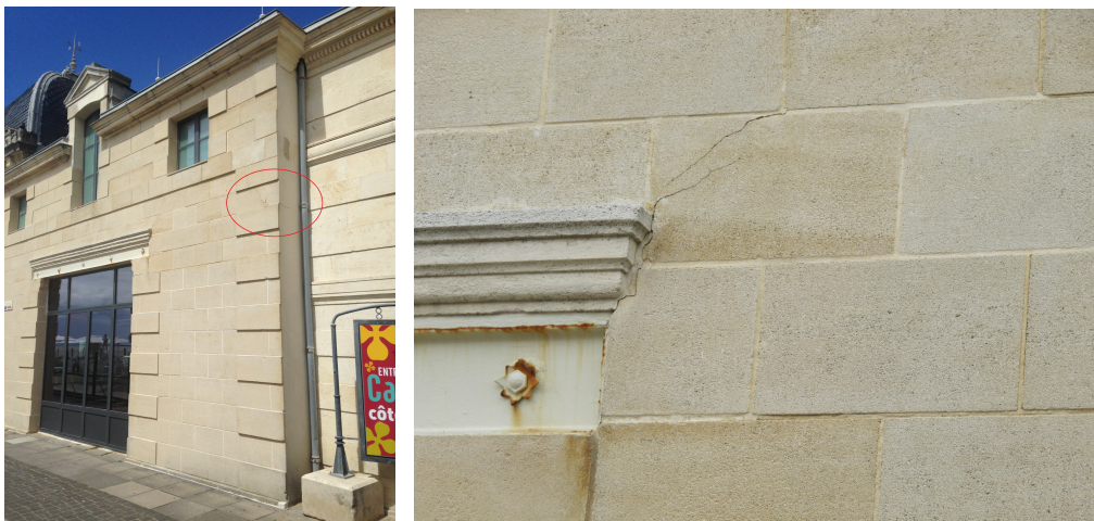
Fig. 17 – Fissure fine de la façade du Casino de Chatelaillon.
