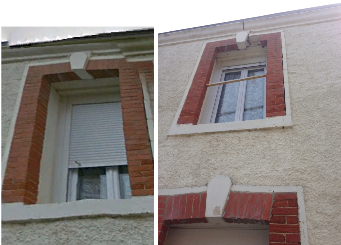
Fig. 14 - Chute de briques dans la partie supérieure de l'encadrement de la fenêtre – rue des dunes. (photo de gauche 2013, photo de droite 28 avril 2016).
