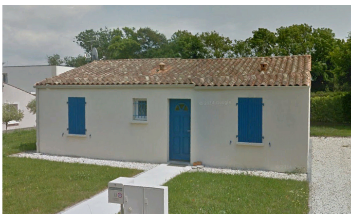
Fig. 29 – Déplacement de faitage ayant entraîné une infiltration, maison basse et récente (vulnérabilité C).
