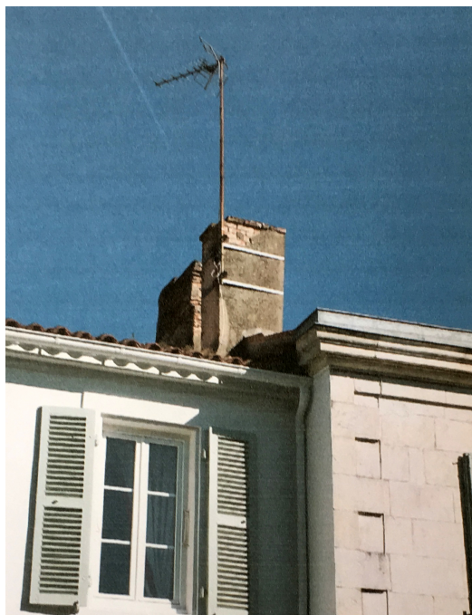
Fig. 42 – Fragilisation des cheminées (2016).
