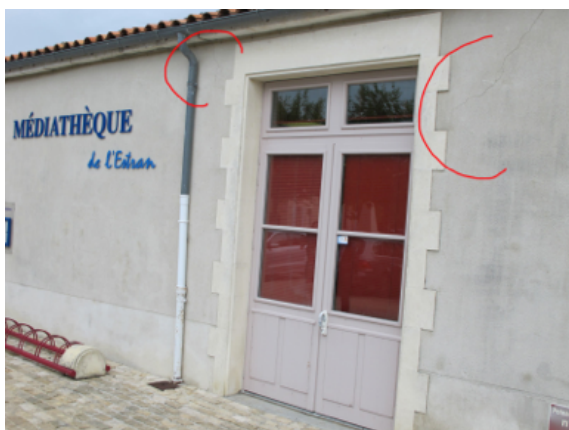
Fig. 24 – Fissures fines sur mur porteur (vulnérabilité A).
