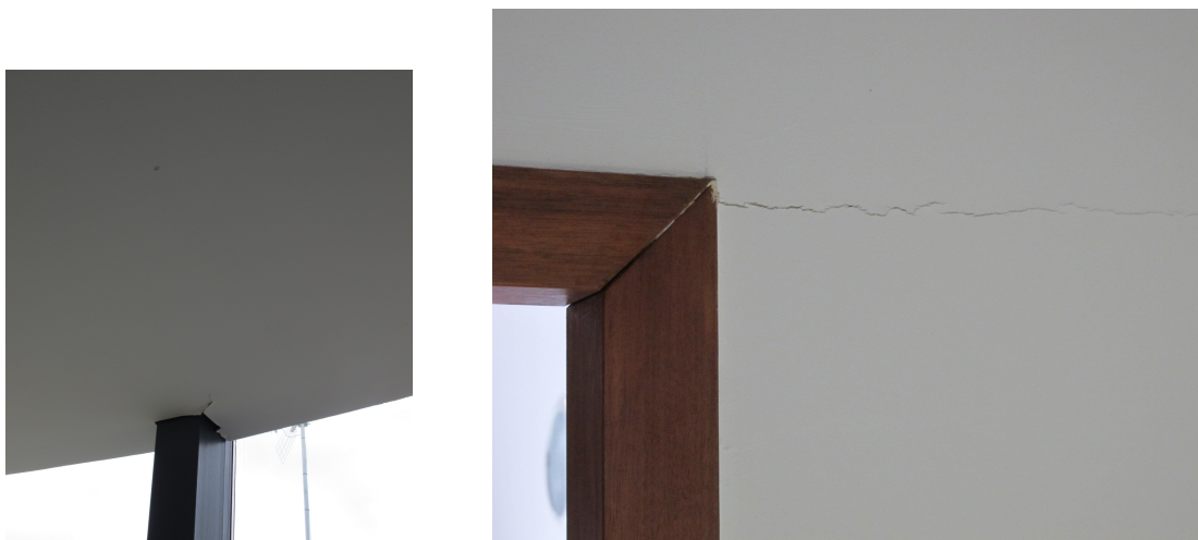
Fig. 20 - Dommages de degré 1- centre Beauséjour (parties en placoplâtre, cloison et faux plafonds).
