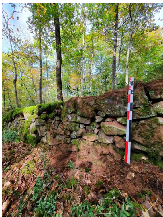
Figure 7: Sur les pentes nord de Montoulieu, le mur repose ici à même le sol avec une étonnante stabilité mais ce n'est, hélas, pas toujours le cas. Les arbres exercent des poussées latérales qui déstabilisent l'ensemble.
