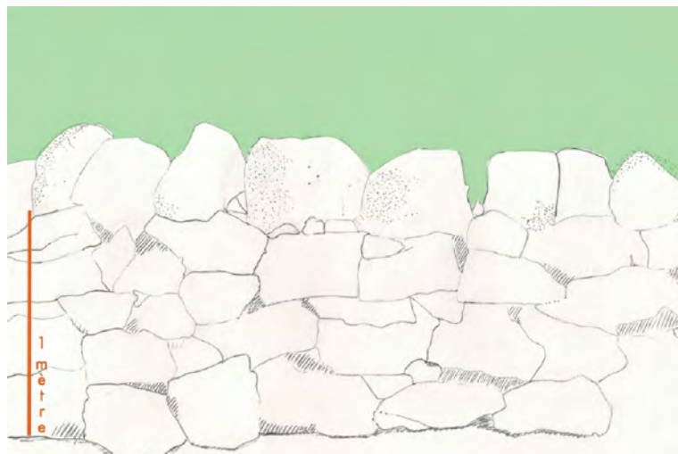
Figure 13: Dessin d'une portion de la maçonnerie au Grand Pas de Pontraute, côté extérieur à la forêt. On y remarque les disjointures et le couronnement très caractéristique du mur.
