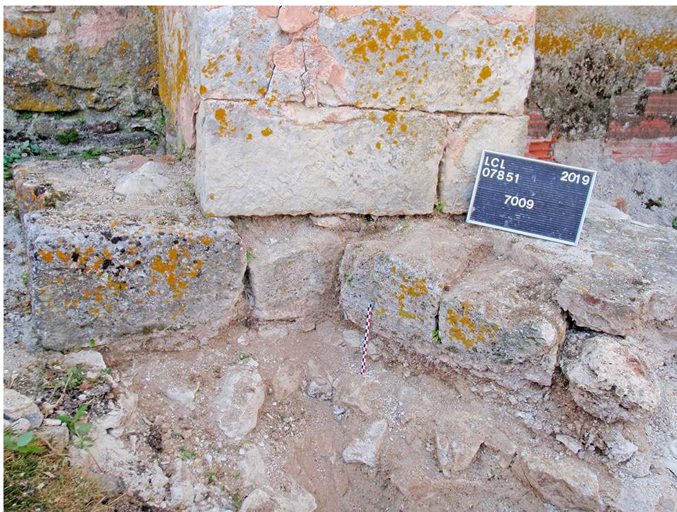
Fig. 6 – Élévation de l'absidiole sud arasée servant d'assise à un contrefort du bras du transept (cl. C. Roms).
