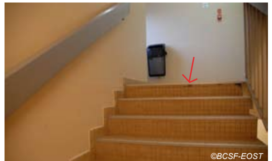
Fig. V-86 : La Trinité - (CH L.D), éclatement de carrelage sur nez de marche.
