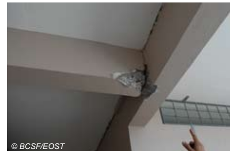
Fig. V-172 : Rivière-Salée - Ecole primaire - dégâts sur partie structurale.
