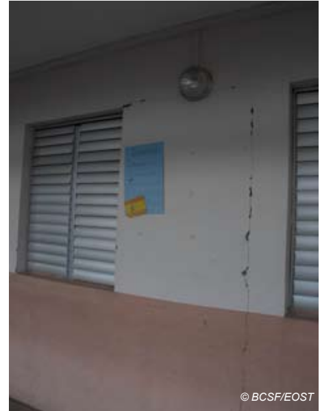
Fig. V-154 : Le François, école Morne Pitault - fissure entre le mur de remplissage et l'ossature.
