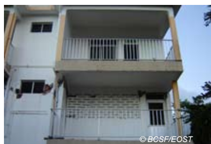
Fig. V-210 : Le Marin - maison individuelle du quartier Huvet - endommagement poteaux-poutres et fissuration dans un mur de remplissage.
