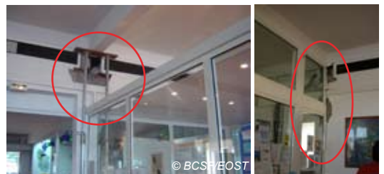
Fig. V-197 : Le Marin - Capitainerie - ruine de poteau en compression.
