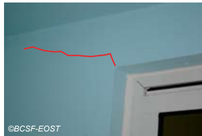
Fig. V-104 : Le Carbet, crèche - fissure en angle de porte.
