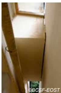
Fig. V-13 : Grand-Rivière - Ecole maternelle - décollement du bâtiment mitoyen.
