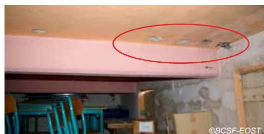
Fig. V-64 : Eclatement de béton suite à infiltration.
