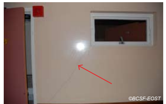
Fig. V-83 : La Trinité - (CH L.D), fissure fine à 45° en angle de fenêtre sur cloison.
