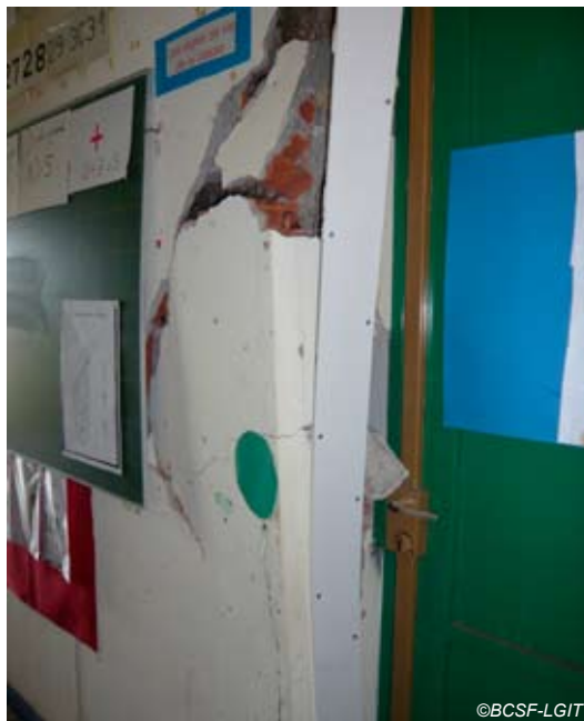
Fig. V-143 : Le Lamentin, école primaire des Roches Carrées - endommagement d'une cloison le long du joint de dilatation.
