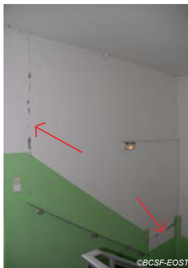
Fig. V-129 : Fort-de-France Immeuble SGBA fissures intérieures entre pilier/dalle et remplissage.
