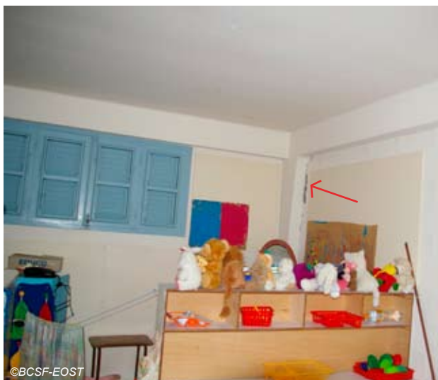
Fig. V-37 : Ecole primaire de Dominante, fissure entre mur de remplissage et structure porteuse.
