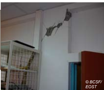
Fig. V-199 : Le Marin, presbytère, rupture d'un poteau.
