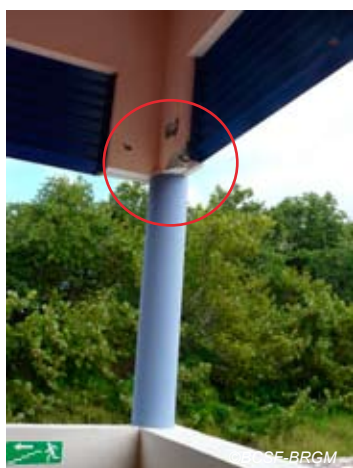
Fig. V-50 : Le Marigot, école primaire de Baignoire - éclatement de béton au niveau de l'attache des jalousies métalliques .
