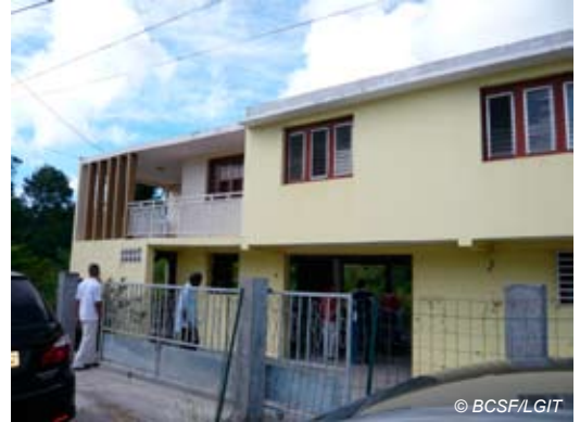
Fig. V 222 : Ferré, Sainte-Anne. La partie avale de la maison a commencé à glisser dans la pente.
