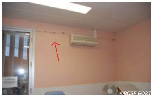
Fig. V-85 : La Trinité - (CH L.D), fissure horizontale.
