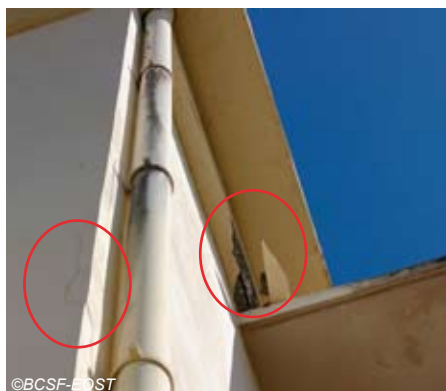
Fig. V-71 : St. Pierre - fissures et chute de mortier.
