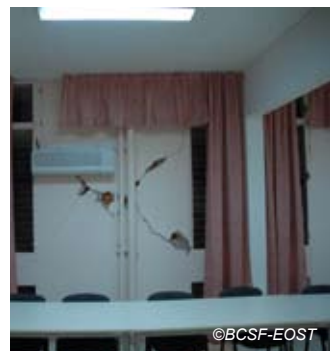
Fig. V-94 : La Trinité - Bâtiment H de l'AFPA - fissure large en X dans mur de remplissage.
