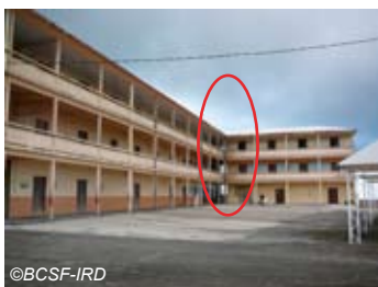
Fig. V-26 : Le Lorrain, école Léon Cécile Carabin, dégâts liés à l'entrechoquement des bâtiments;
