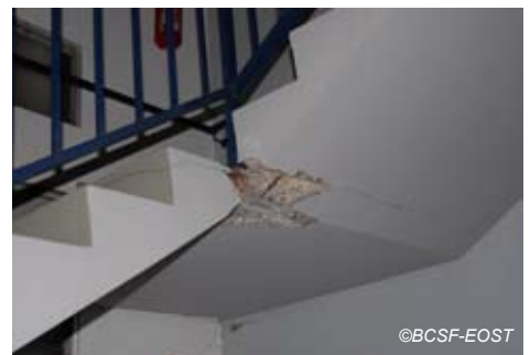
Fig. V-93 : La Trinité - Bâtiment H de l'AFPA - éclatement du béton de couverture par torsion de l'escalier.
