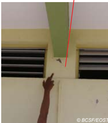
Fig. V-192 : Rivière Pilote - Collège Jacques Roumain - bâtiment D - fissure en X (effet "poteau court").
