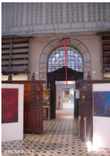
Fig. V-131 : Fort-de-France Bibliothèque Schoelcher, rares dégâts sur ornementation en plâtre.
