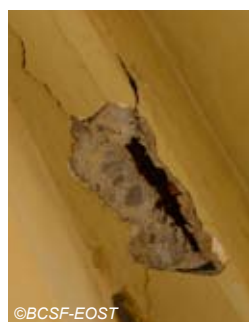
Fig. V-65 : Eclatement de béton sur élément corrodé.
