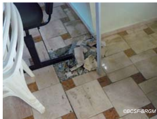
Fig. V-53 : Mairie de Sainte-Marie - décollement de carrelage au sol.
