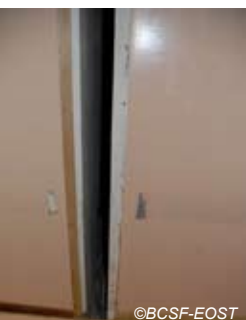
Fig. V-84 : La Trinité - (CH L.D), joint de dilatation.
