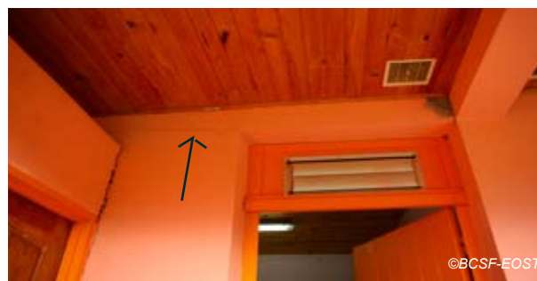
Fig. V-51 : Le Marigot, école maternelle du Bourg - fissure légère mur porteur.
