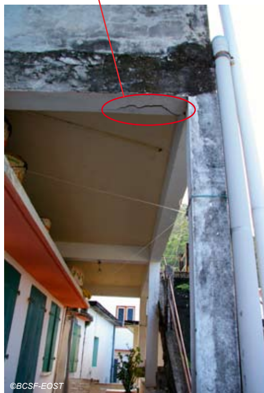
Fig. V-17 : Grand-Rivière, dégâts structuraux légers. (relation avec le séisme incertain).
