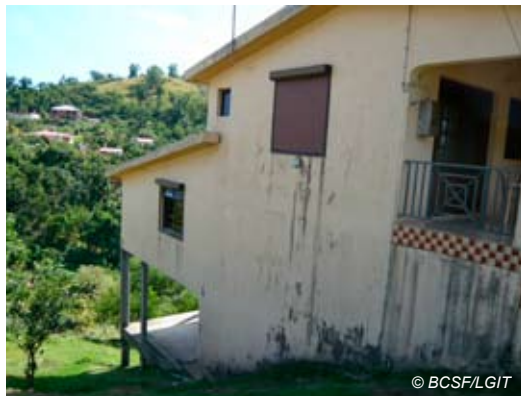
Fig. V 223 : Ferré, Sainte-Anne. La partie avale de la maison a commencé à glisser dans la pente.
