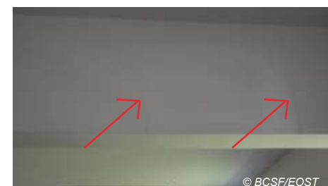
Fig. V-174 : Rivière-Salée, Sécurité sociale - fissures fines induites par la flexion de la poutre.
