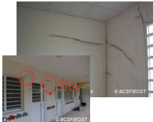
Fig. V-191 : Rivière Pilote - Ecole maternelle Manikou - fissures fines en cours de réparation (murs porteurs).
