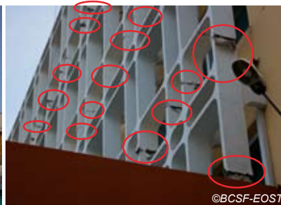
Fig. V-126 : Fort-de-France Immeuble SGBA façade est, détail des ruptures au niveau des joints.
