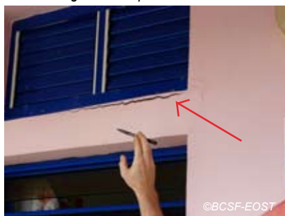
Fig. V-48 : Le Marigot, école primaire de Baignoire fissure sur linteau.
