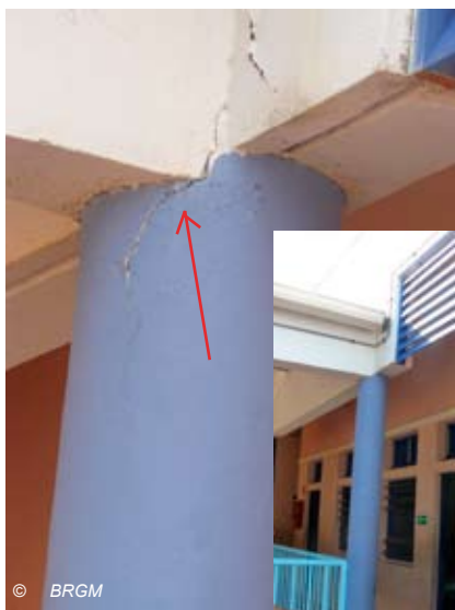
Fig. V-46 : Le Marigot, école primaire de Baignoire - endommagement de pilier.
