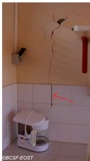
Fig. V-38 : Ecole primaire de Dominante, fissure légère et éclatement de carrelage.
