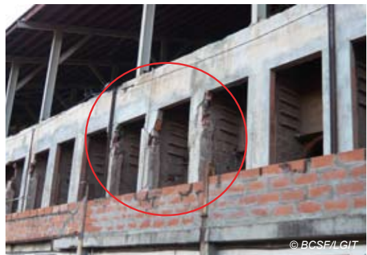
Fig. V-165 : Trois-Ilets, poterie, rupture de poteaux en briques maçonnées.
