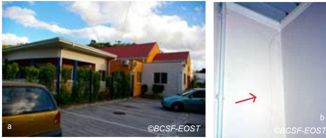
Fig. V-103 : Le Carbet, crèche comportant quelques microfissures, vulnérabilité D-E (terrain plat et mou).
