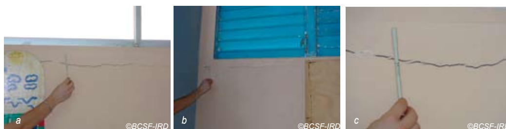
Fig. V-21 : Basse-Pointe - exemples de fissures fines horizontales rencontrées dans l'école mixte.
