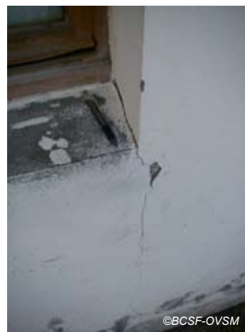
Fig. V-115 : Bellefontaine - maison individuelle - fissure non liée aux effets du séisme.
