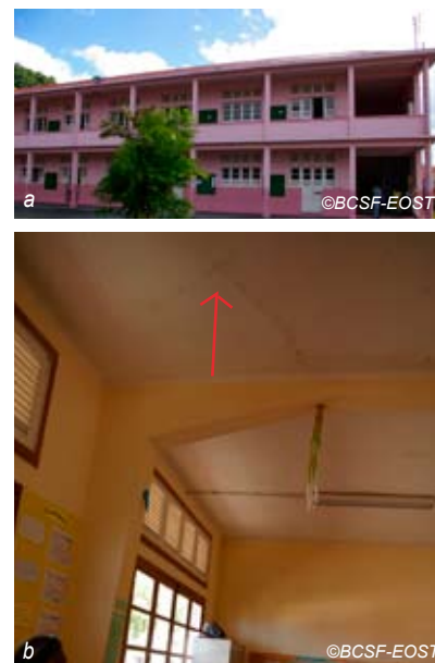
Fig. V-69 : St. Pierre - Ecole Philemont-Montout - fissure fine sur dalle plafond (rare dégât de niveau 1).
