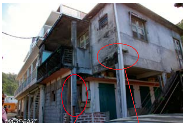
Fig. V-15 : Grand-Rivière - Pilier défectueux antérieur au séisme représentant un élément de grande vulnérabilité et n'ayant pas été endommagé d'avantage.
