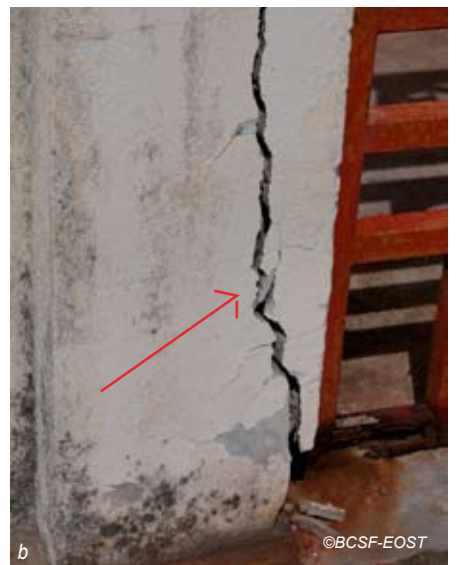
Fig. V-66 : Saint-Pierre centre - exemples de fissures observées sur quelques maisons individuelles en structure poteau/poutre et remplissage. (vulnérabilité A et B).
