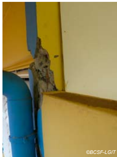
Fig. V-140 : Le Lamentin, école Bas Mission, dégâts sur "poteau court".
