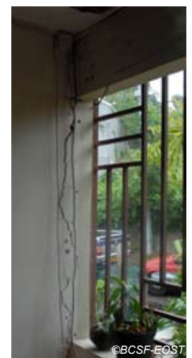
Fig. V-119 : Schoelcher, fissure entre le mur extérieure et la cloison.
