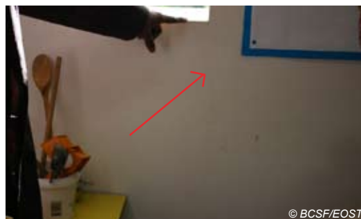
Fig. V-162 : St.-Esprit - Ecole mixte B (annexe) - rares dégâts de niveau 1.
