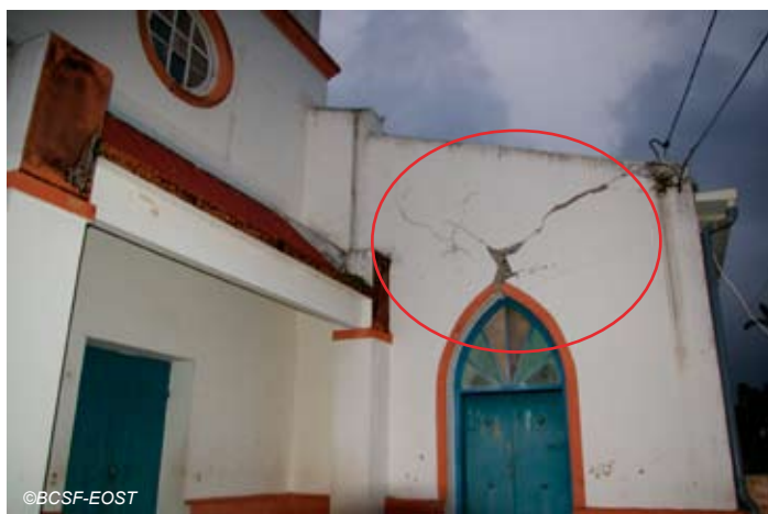
Fig. V-58 : Sainte-Marie, église Mornes des Esses, fissure large et traversante (mur en moellons).
