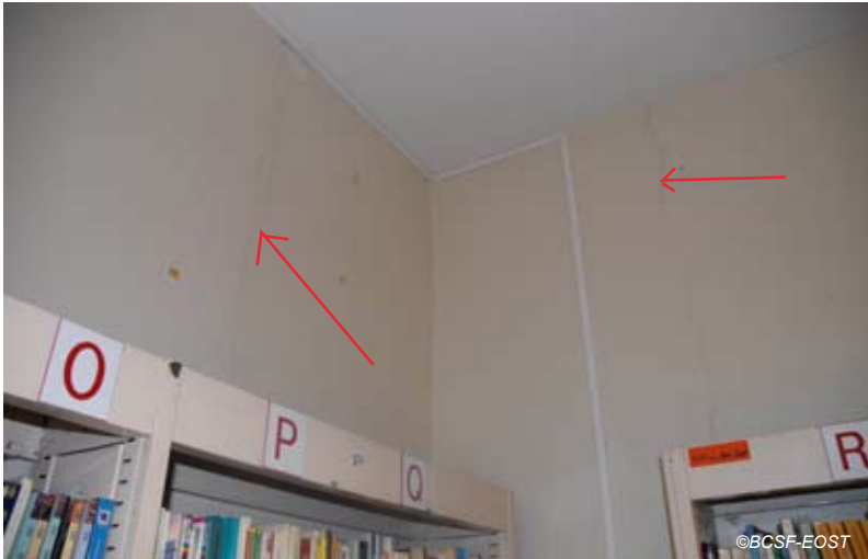
Fig. V-132 : Fort-de-France - Bibliothèque Schoelcher, fissures fines (partie récente).
