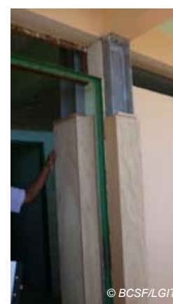
Fig. V-216 : Sainte-Luce - école Mixte A, effet "poteau court" (réparé lors de la visite).
