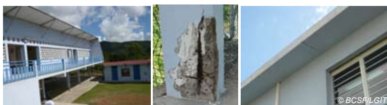
Fig. V-184 : Le Diamant - Ecole du Morne Blanc, décollement de béton, fissure dans la dalle du toit.
