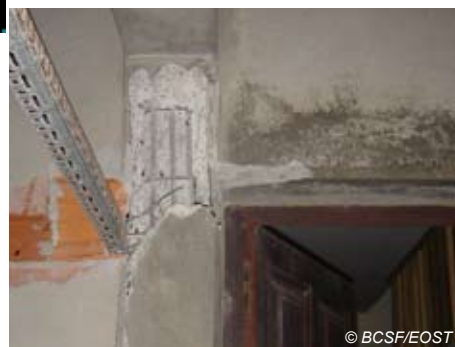
Fig. V-212 : Le Marin - maison individuelle du quartier Huvet. endommagement d'un pilier.
