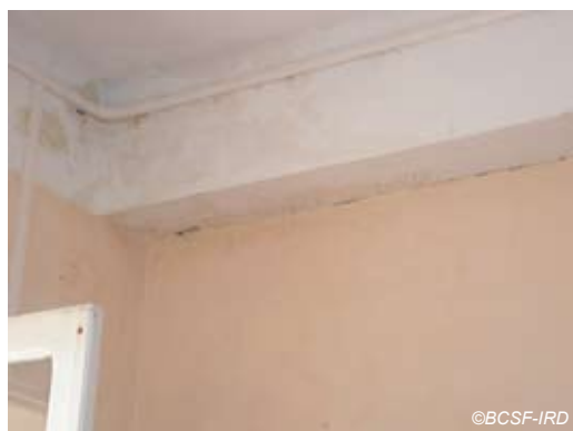
Fig. V-19 : Basse-Pointe - réfectoire - fissure fine entre structure et mur de remplissage.
