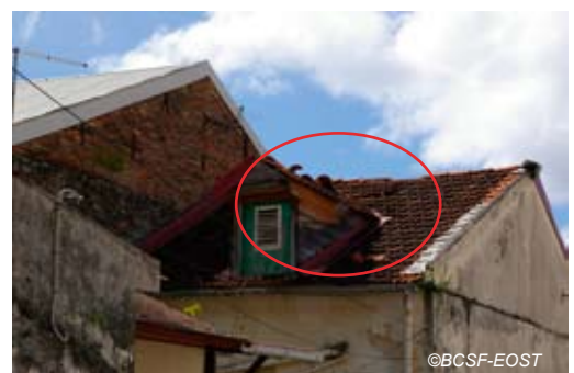
Fig. V-67 : Saint-Pierre centre - maison individuelle, chute de tuiles.
