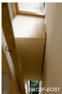
Fig. V-13 : Grand-Rivière - Ecole maternelle - décollement du bâtiment mitoyen.
