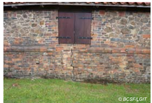
Fig. V-164 : Trois-Ilets, poterie, fissure ouverte dans maçonnerie de briques.
