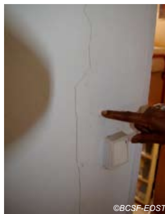
Fig. V-14 : Grand-Rivière - Maison individuelle - fissure fine dans mur non porteur (dégât de niveau 1).
