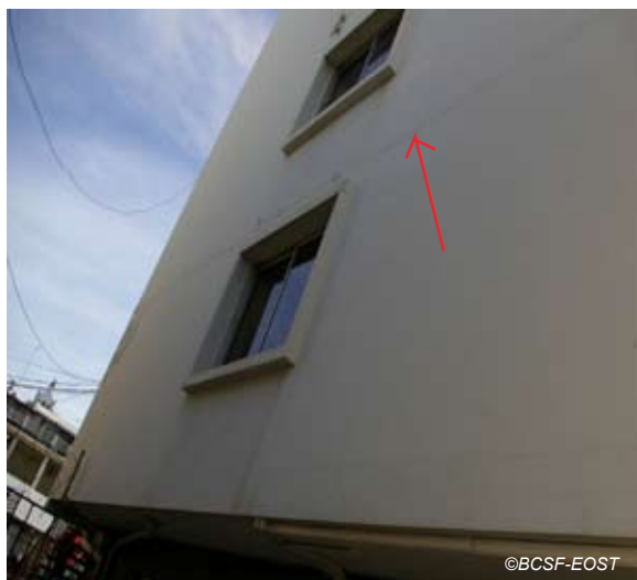
Fig. V-134 : Fort-de-France - bâtiment D de la préfecture, fissuration du pignon.
