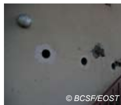
Fig. V-201 : Le Marin, presbytère - éclatement de mur en maçonnerie d'élément préfabriqués.
