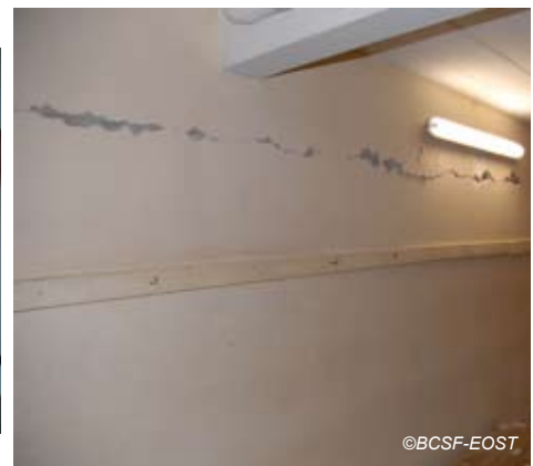
Fig. V-95 : La Trinité - Bâtiment H de l'AFPA - fissure horizontale.
