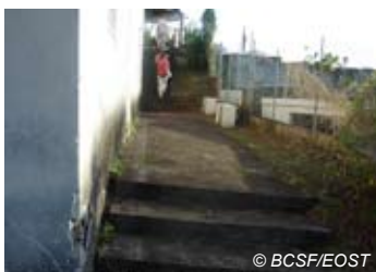
Fig. V-200 : Le Marin, presbytère, présence avant séisme d'une inclinaison du terrain vers le talus.
