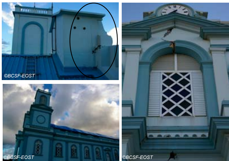
Fig. V-54 : Eglise de Sainte-Marie - fissuration large et traversante du fronton (mur en moellons).
