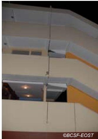
Fig. V-80 : La Trinité, école Auguste Réjon dégât au droit du raccordement de l'escalier.
