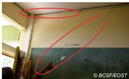
Fig. V-193 : Rivière Pilote - Collège Jacques Roumain - exemple de fissures traversantes sur voile de béton (Pré-existence ?) et traces de mouvement de la dalle.
