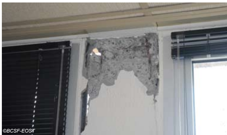
Fig. V-127 : Fort-de-France, Immeuble SGBA, éclatement de béton de pilier porteur (3 ème étage).
