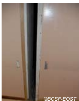
Fig. V-84 : La Trinité - (CH L.D), joint de dilatation.
