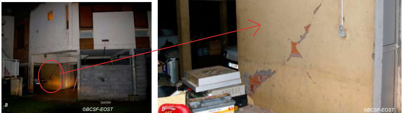
Fig. V-61 : Maison individuelle en ossature béton armé et remplissage en maçonnerie (parpaings et briques). Dégâts sur les piliers et les murs de remplissage (fissure en X).
