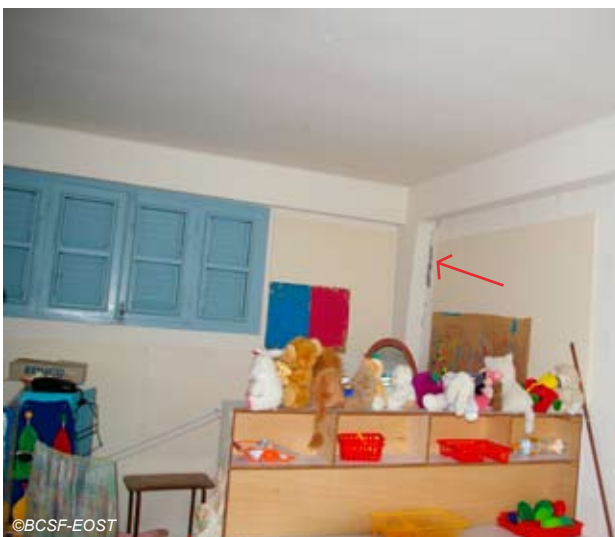
Fig. V-37 : Ecole primaire de Dominante, fissure entre mur de remplissage et structure porteuse.
