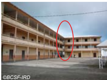
Fig. V-26 : Le Lorrain, école Léon Cécile Carabin, dégâts liés à l'entrechoquement des bâtiments;
