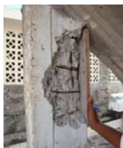
Fig. V-182 : Le Diamant, école du Bourg - éclatement de béton de couverture.
