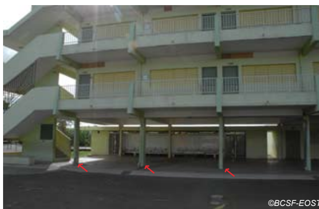
Fig. V-148 : Le François - Ecole Anne Marc - RC transparent, endommagement en pied de piliers.
