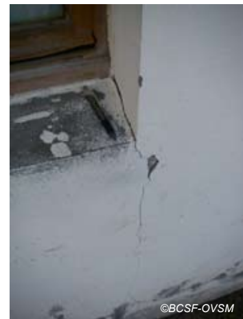
Fig. V-115 : Bellefontaine - maison individuelle - fissure non liée aux effets du séisme.
