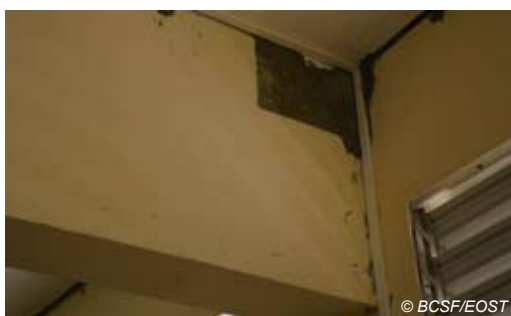
Fig. V-194 : Rivière Pilote - Collège Jacques Roumain - dégâts sur poutre porteuse.
