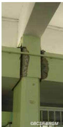
Fig. V-145 : Le François - Ecole Anne Marc, éclatement de mortier suite à l'entrechoquement du pilier du bâtiment principal avec la dalle du bâtiment accolé.
