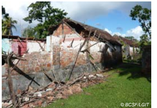
Fig. V-168 : Trois-Ilets, poterie, effondrement d'une cabane d'esclave en maçonnerie de briques.
