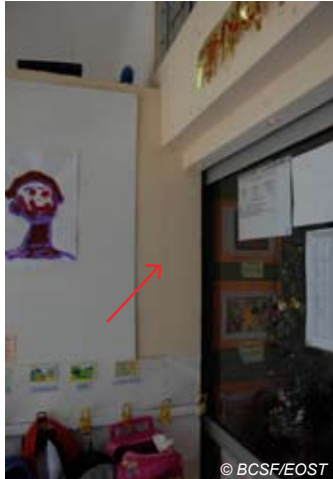
Fig. V-175 : Rivière-Salée - Ecole maternelle de Trénelle - fissure fines.
