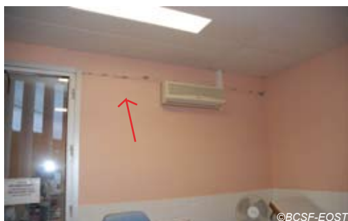
Fig. V-85 : La Trinité - (CH L.D), fissure horizontale.
