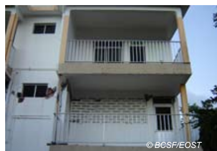
Fig. V-210 : Le Marin - maison individuelle du quartier Huvet - endommagement poteaux-poutres et fissuration dans un mur de remplissage.
