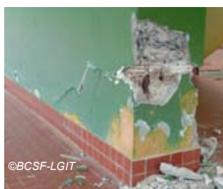
Fig. V-142 : Le Lamentin, école primaire des Roches Carrées, éclatement du béton de couverture du voile longitudinal.
