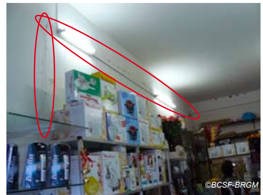
Fig. V-22 : Le Lorrain - Magasin ayant connu la chute d'objets et des fissures de niveau 2;
