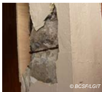
Fig. V-183 : Le Diamant, école du Bourg - décollement de béton sur un pilier (infiltration d'humidité préexistantes).
