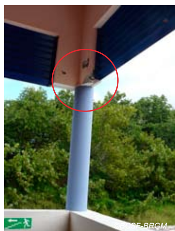
Fig. V-50 : Le Marigot, école primaire de Baignoire - éclatement de béton au niveau de l'attache des jalousies métalliques .
