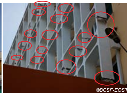
Fig. V-126 : Fort-de-France Immeuble SGBA façade est, détail des ruptures au niveau des joints.
