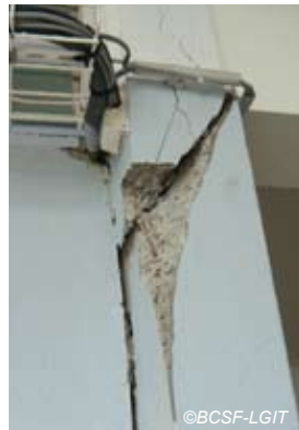
Fig. V-92 : La Trinité - Bâtiment H de l'AFPA - Rupture d'un poteau par effort tranchant .
