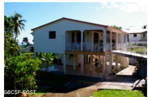
Fig. V-31 : Ajoupa-Bouillon, maison individuelle très vulnérable ne souffrant d'aucun dégât -selon interview de la propriétaire (asymétrie de plan et RDC transparent).
