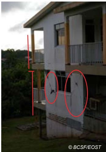
Fig. V-207 : Le Marin - maison individuelle du quartier Huvet - dégâts structuraux de niveau 3 (fissurations en X dans des murs de remplissages), défaut d'alignement des poteaux.
