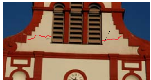
Fig. V-156 : Ducos - Fissuration du clocher de l'église.
