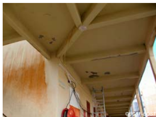
Fig. V-63 : Eclatement de béton (présence de corrosion).
