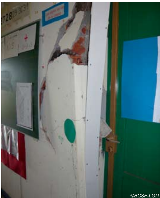
Fig. V-143 : Le Lamentin, école primaire des Roches Carrées - endommagement d'une cloison le long du joint de dilatation.
