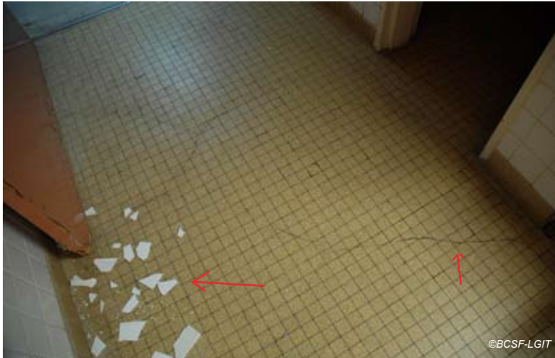
Fig. V-87 : La Trinité - (CH L.D), chute de morceaux de carrelage mural et fissures au sol.
