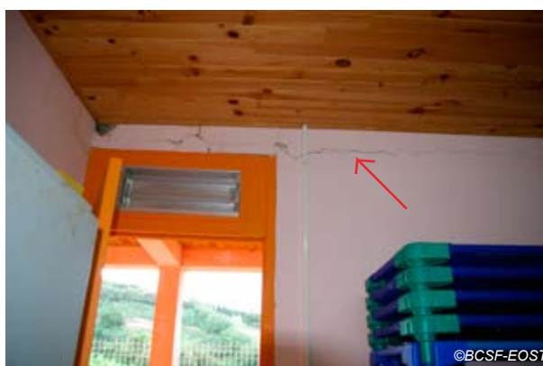
Fig. V-49 : Le Marigot, école maternelle du Bourg - fissure légère mur porteur.
