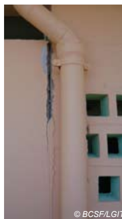
Fig. V-215 : Sainte-Luce - école Mixte A, légère fissuration en raccord de murs.
