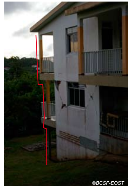
Fig. V-5 : Le Marin - Défaut d'alignement des piliers de terrasse.
