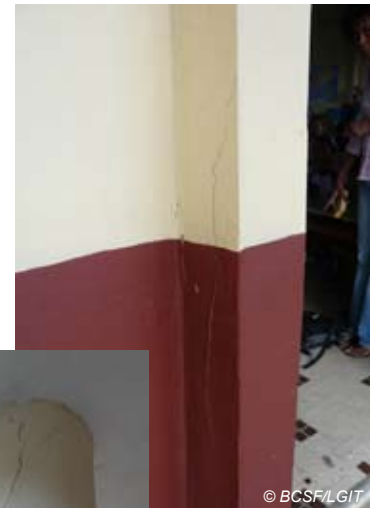
Fig. V-179 : Anses d'Arlet - Ecole Lucea - fissuration dans un poteau peut-être liée à du décollement préexistant du béton.
