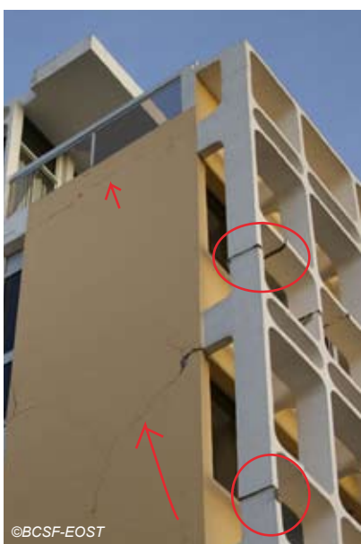
Fig. V-128 : Fort-de-France Immeuble SGBA façade est, détails des ruptures.
