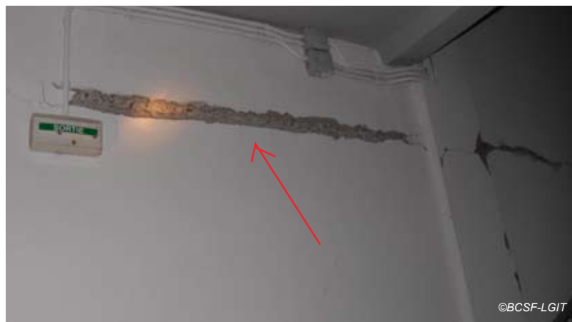
Fig. V-89 : La Trinité, bâtiment E de l'AFPA - fissure horizontale dans béton banché.
