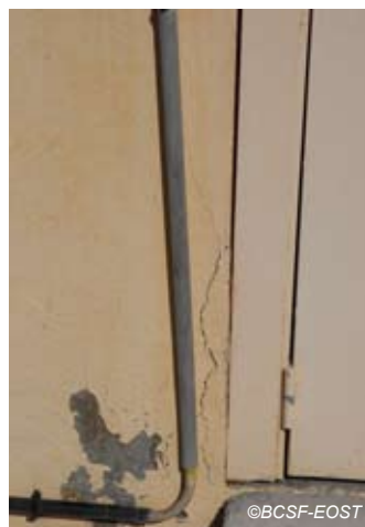
Fig. V-117 : Case-Pilote, école primaire Saint-Just Orville -fissure légère le long d'une huisserie de porte.
