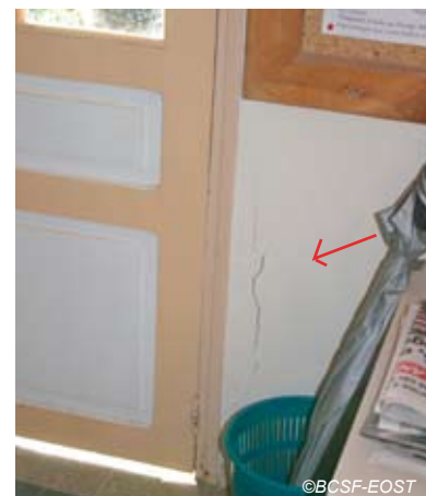
Fig. V-100 : Le Carbet, CCAS - bâtiment de vulnérabilité A - dégât structural léger.
