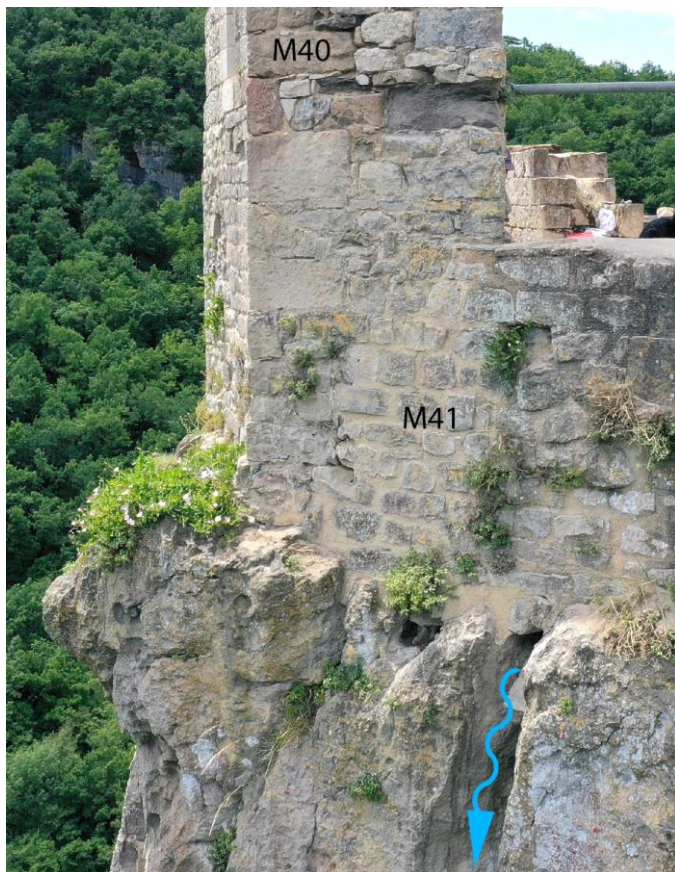
Fig. Diaclase servant à l'évacuation. Photo Denis Langlois
