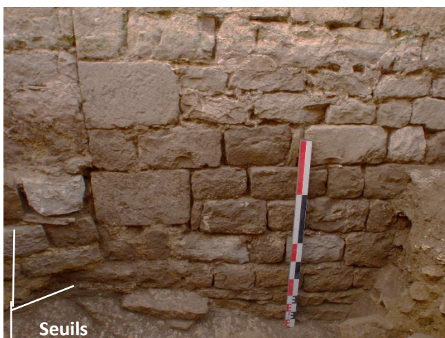
Fig. Aspect parement externe du M75 en zone 1. À gauche, bouchons (M74). Photo Aubane Priol et Gabriel Vialatte
