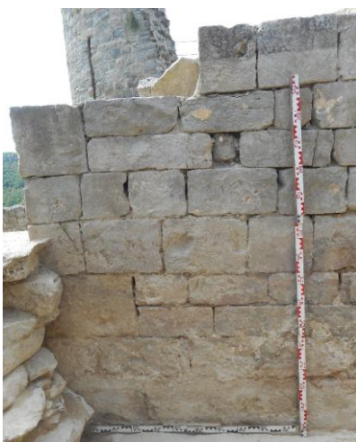
Fig. Parement externe M68 en zone 4. Notez le boulon bouché. Photo Yasmine Greis, Alice Poirier
