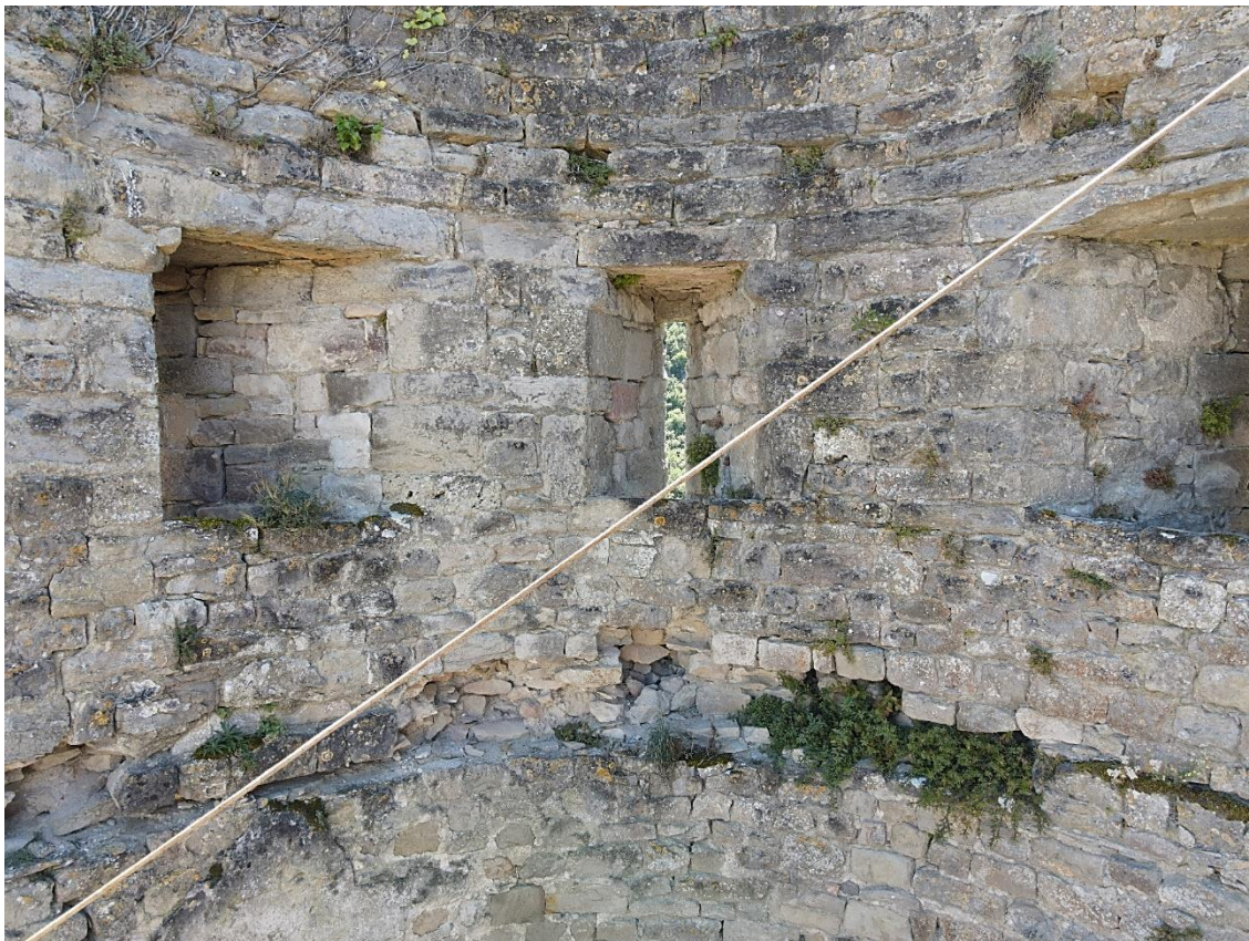
Fig. Parement interne de la tour au niveau des ouvertures de tir. Photo Florence Guillot.
