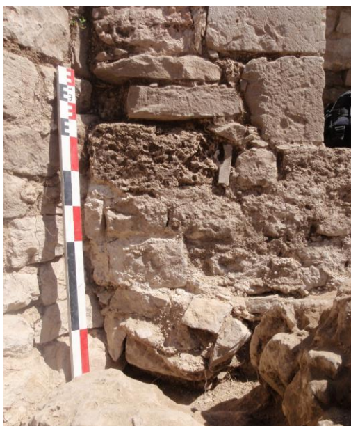
Fig. Parement interne M41 (à gauche) / M40 (à droite). Coup de sabre et moellons en tuf.
