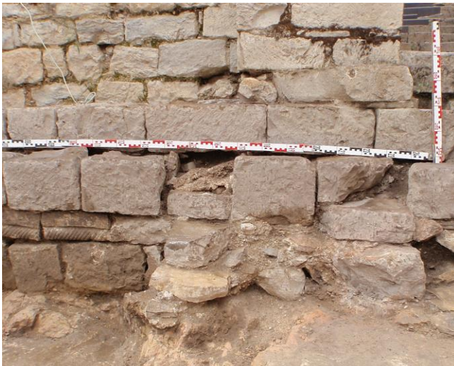
Fig. Dégradation du M76 et insertion du muret 2. Photo Aubane Priol et Gabriel Vialatte
