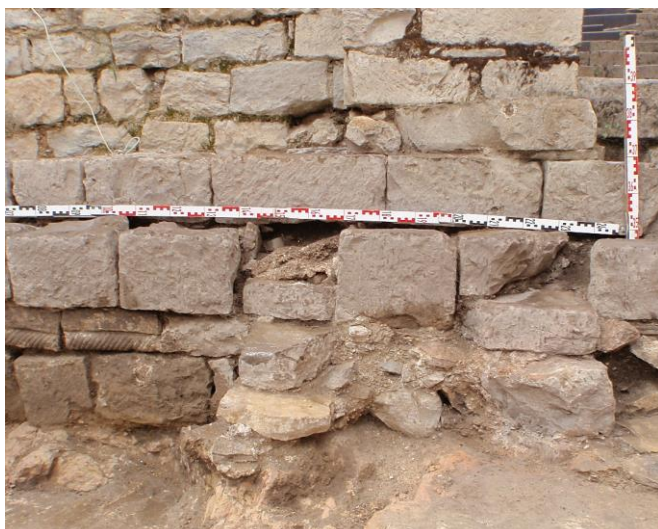
Fig. Dégradation du M76 et insertion du muret 2. Photo Aubane Priol et Gabriel Vialatte
