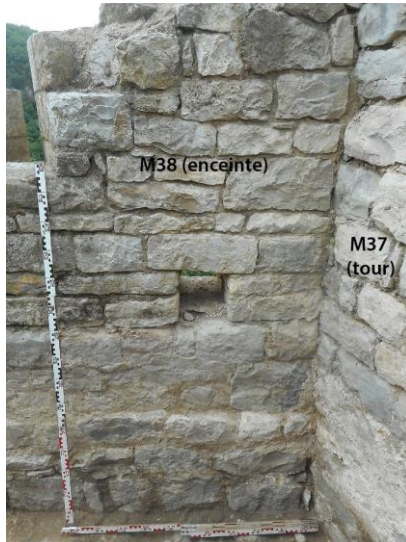
Fig. Absence de chaînage M37/M38 et élargissement de la fondation du M38.
