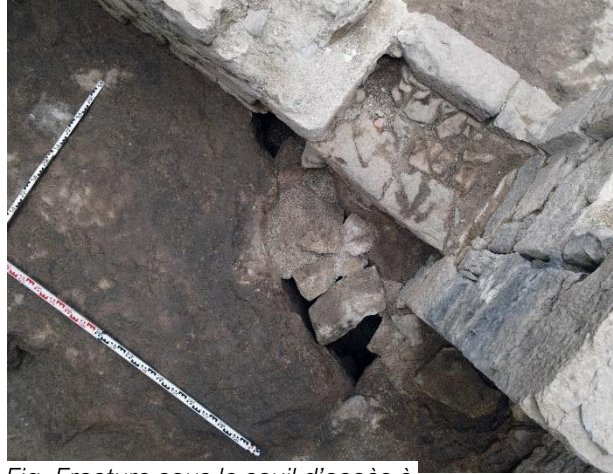
Fig. Fracture sous le seuil d'accès à la tour. Photo Florence Guillot
