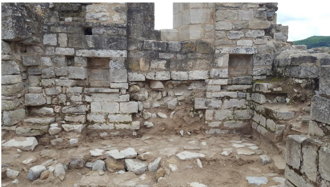
Fig. Arrachement du parement interne du M39 à l'emplacement de l'autel. Photo Romain Valette
