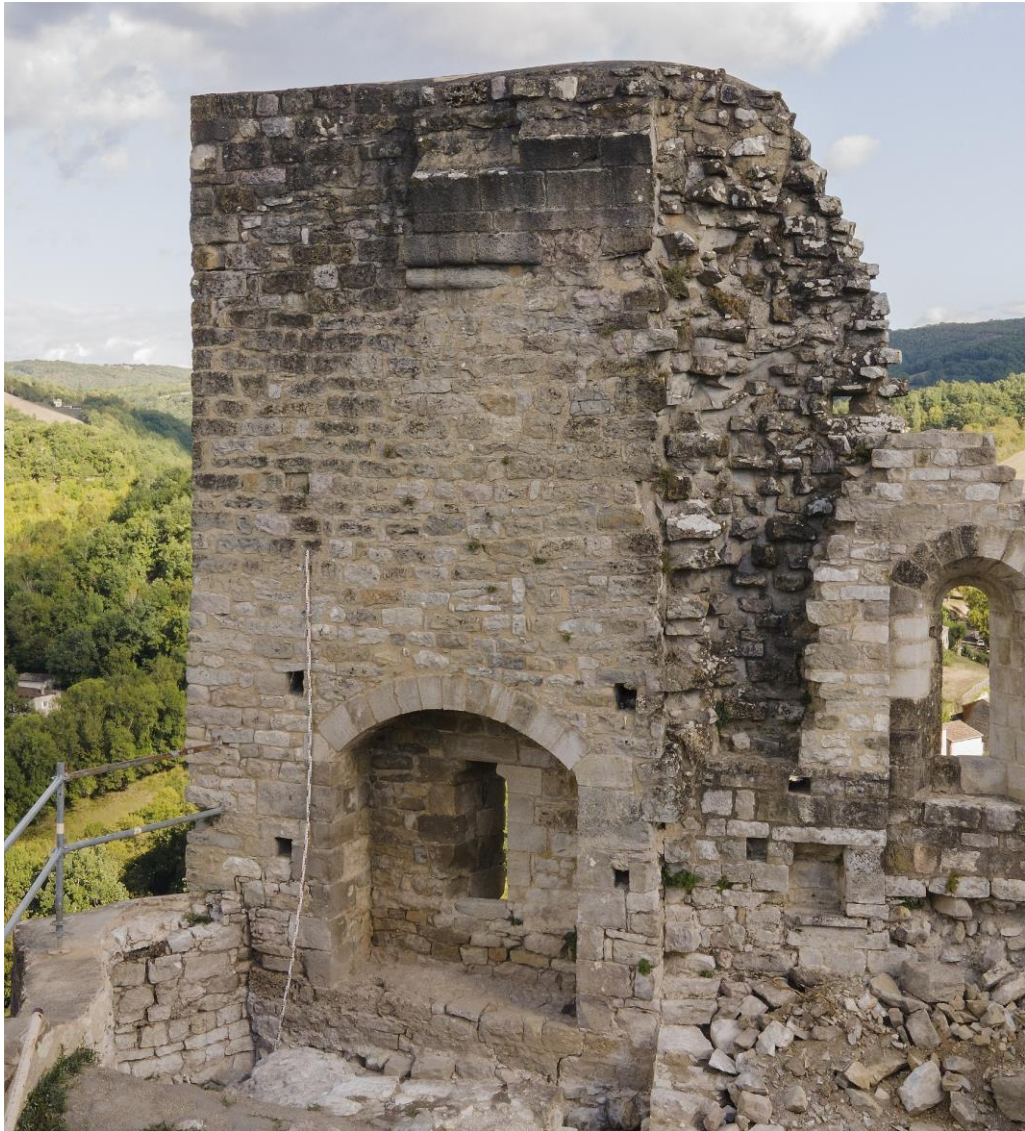
Fig. Parement interne pseudo tour (M40). Le parement externe est présenté sur la dernière figure de la zone 7. Photo Florence Guillot
