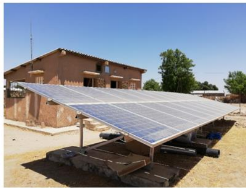
Site de la mini-centrale de Kéré, exploitée par SALENSOL
