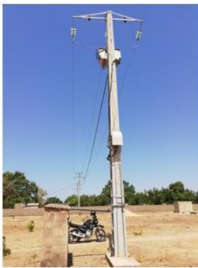
Point de jonction entre le réseau moyenne-tension de Sénélec et le réseau basse-tension exploité par NSRESIF, village de Diaglè.
