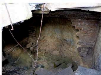
Figures 5. Effondrement d'une cave dans la commune d'Ancerville (55)
