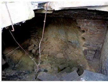
Figures 5. Effondrement d'une cave dans la commune d'Ancerville (55)
