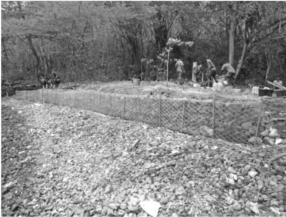
Fig. 2 – Les Anses d'Arlet – Anse Bellay. Un treillis métallique est positionné devant la microfalaise (© SRA Martinique).
