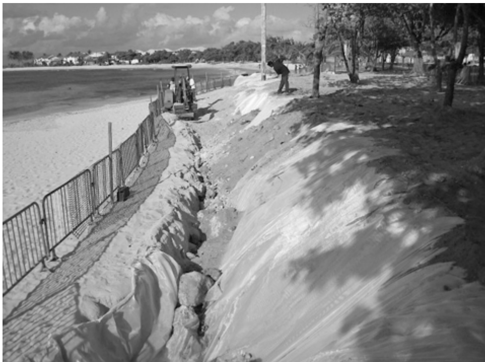
Fig. 3 – Pose du dispositif de protection provisoire au cimetière des Raisins-Clairs à Saint-François en Guadeloupe. Un géotextile emballe la microfalaise (© C. Stouvenot).
