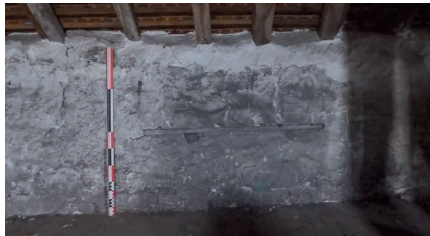
Fig. 71 Vue de l'une des trois anciennes ouvertures à présent murées et dont l'appui correspond au bois horizontal. Cliché : N. Warmé, Inrap
