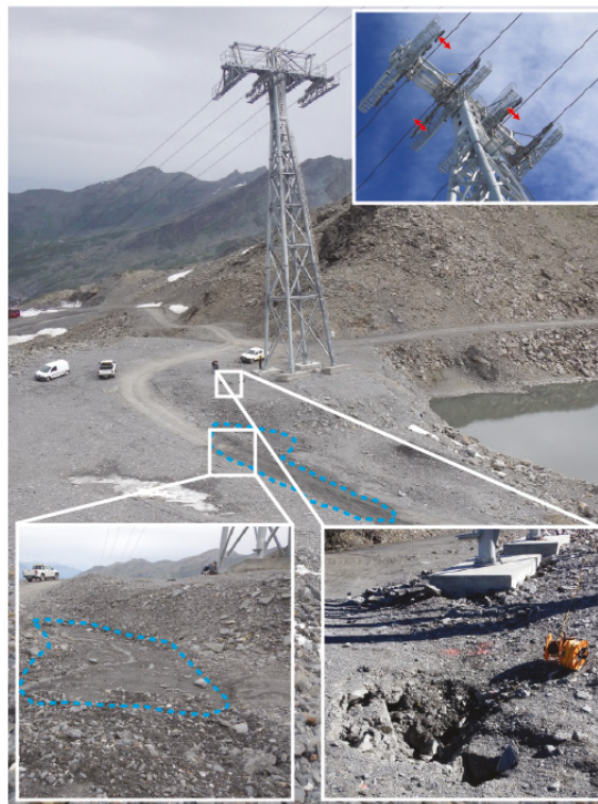
Fig. B : Déstabilisation du pylône n°2 du funitel de Thorens en 2016.
