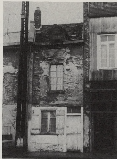
— Mur extérieur à ossature de bois = Mur extérieur en maçonnerie de brique.
