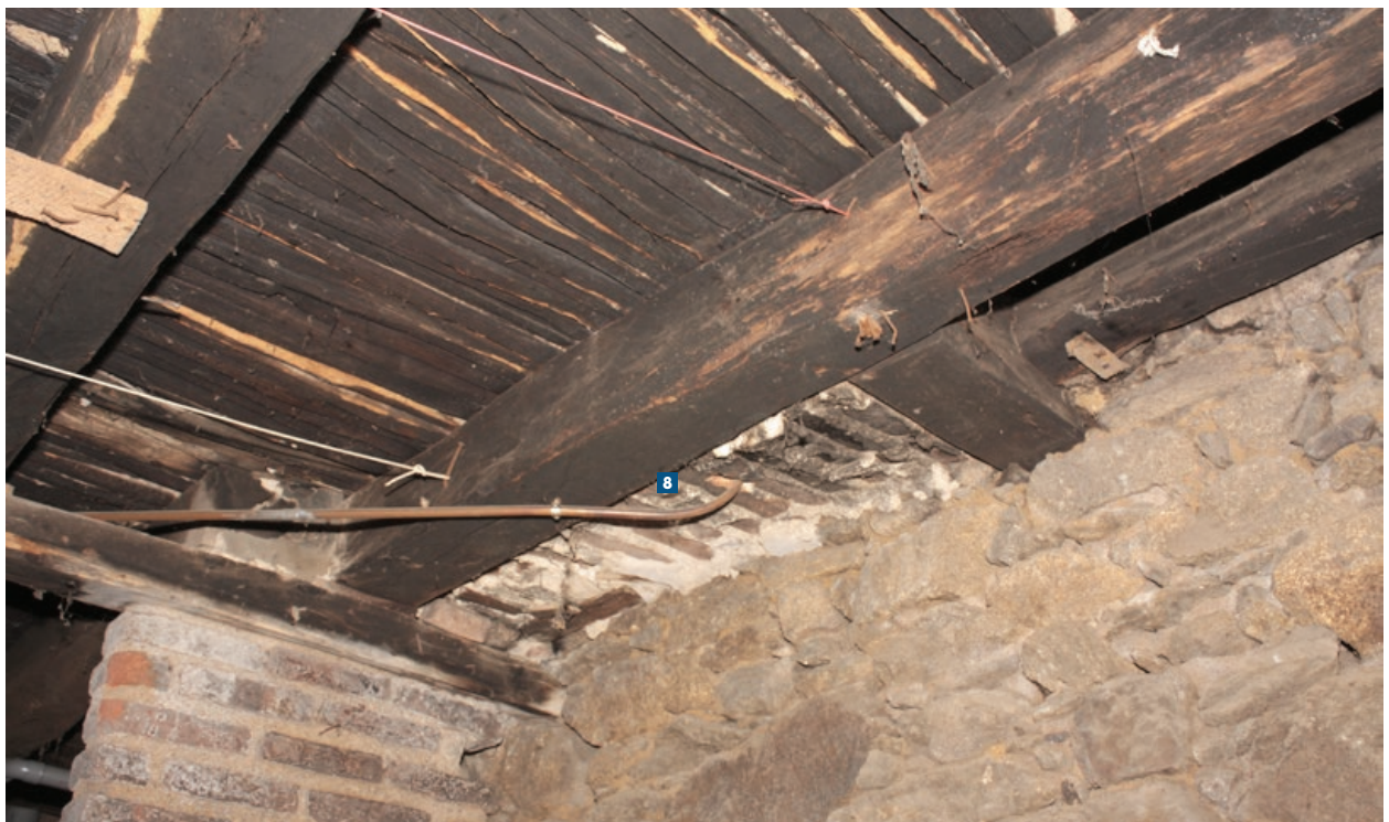
Détail du plancher cave du logement 3 dans son état en 2009 avec ses surfaces noircies.
