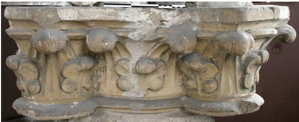
Fig. 10 - Troisième chapiteau nord de la nef, déposé (inv. 127).
