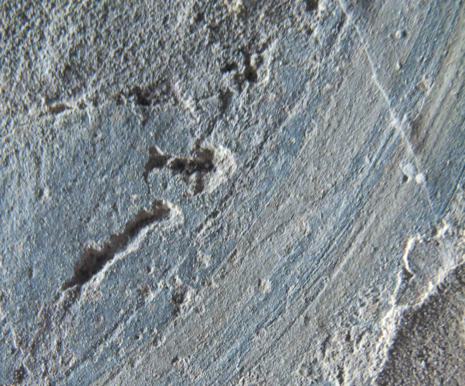
Fig. 10 : Église de Saint-Martin-des-Puits, chœur (mur est) : tracé incisé sur enduit frais. Droits de reproduction : SINOPIA.
