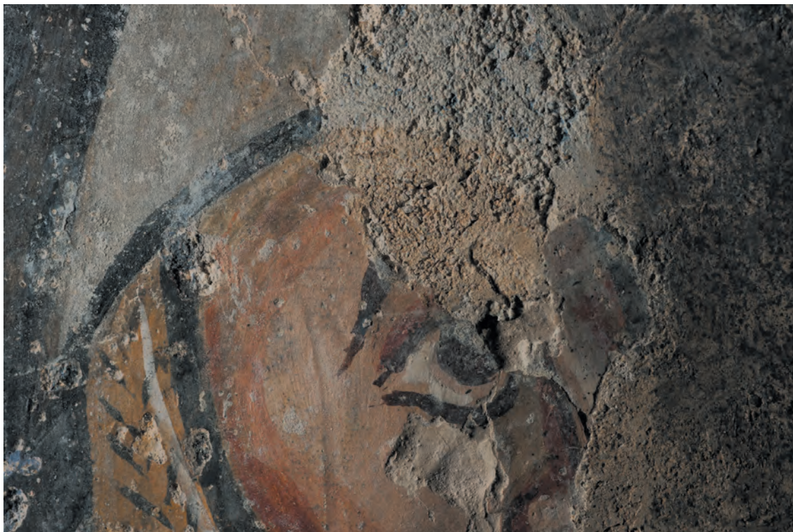
Fig. 16 : Église de Saint-Martin-des-Puits, chœur (mur est) : cavalier (détail de l'œil). Droits de reproduction : O. Guillon — CICRP.
