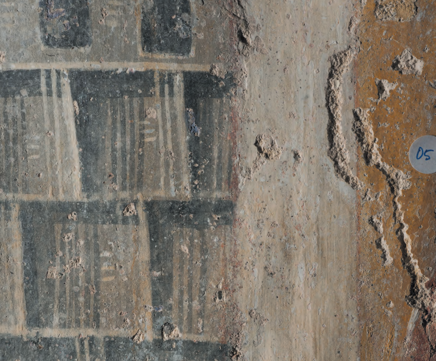
Fig. 8 : Église de Saint-Martin-des-Puits-Chœur (mur est) : détail d'un joint d'enduit vertical et implantation préparatoire à l'ocre rouge. Droits de reproduction : O. Guillon — CICRP.
