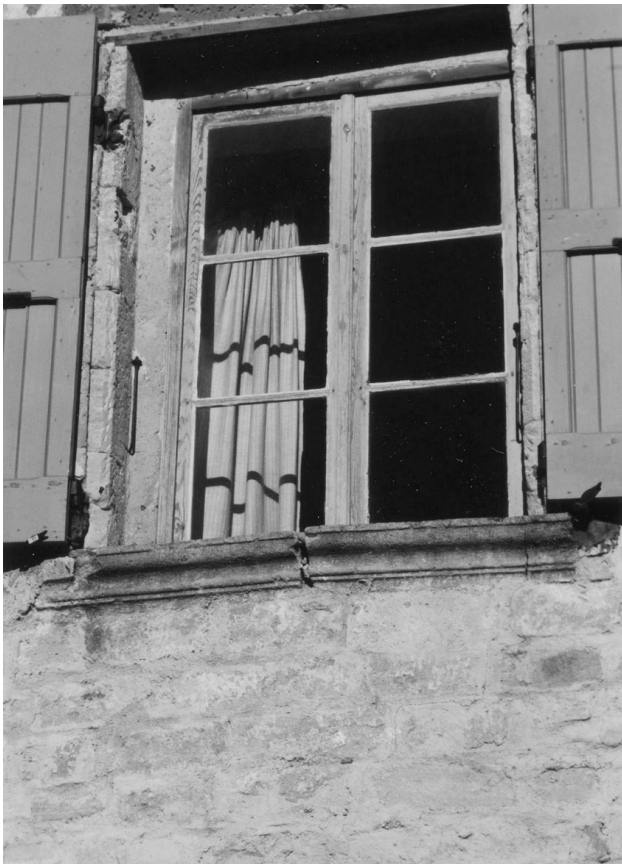
Fig. 6.7 Appui de fenêtre fendu à Saint-Martin-les-Eaux (photo G. Poursoulis, 2001)
