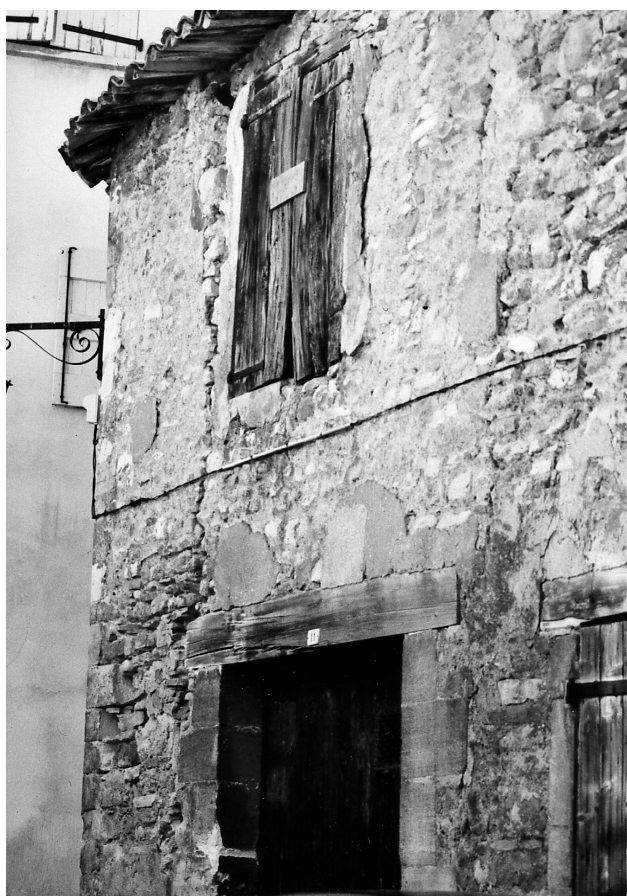
Fig. 6.5 Fissure verticale plus ouverte en haut à l'angle de la façade d'une maison à Manosque dans le quartier des Payants (photo G. Poursoulis, 2001)
