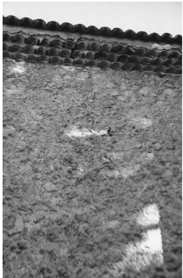
Fig. 6.10 Fissure bouchée avec des briquettes, façade de l'église de Notre-Dame de Toutes-Aures (photo G. Poursoulis, 2001)
