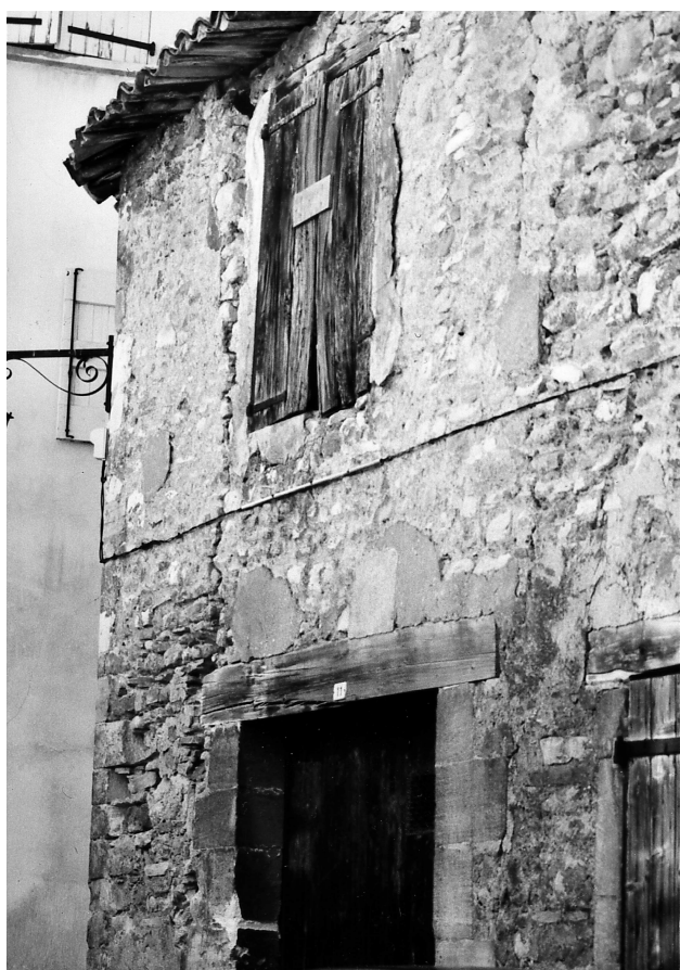
Fig. 6.5 Fissure verticale plus ouverte en haut à l'angle de la façade d'une maison à Manosque dans le quartier des Payants (photo G. Poursoulis, 2001)
