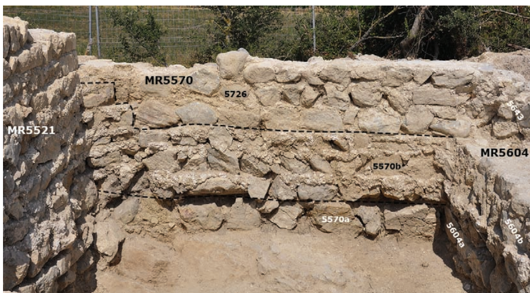
Fig. 26 : Vue générale du parement occidental de MR5570. L'assise de fondation US5570b, liée au mortier, débord largement l'assise de fondation US5570a, liée à la terre, attestant de la présence d'un mur antérieur à MR5570 (©V. Mathieu-CNRS).
