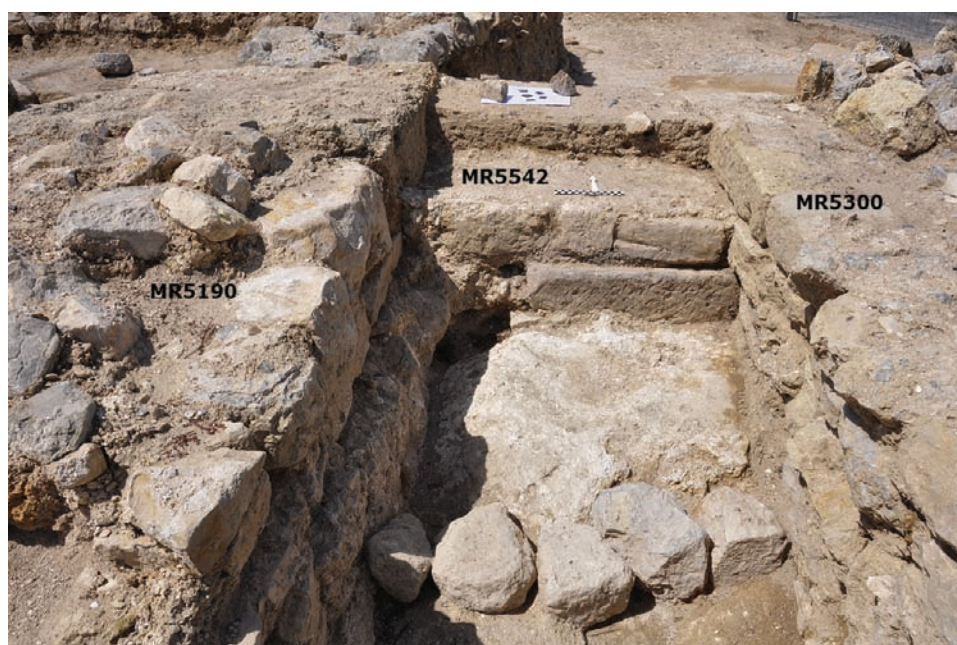
Fig. 5 : Au nord de l’Esp507, vue sur la fondation de MR5190 (à gauche du cliché), qui semble être fondée en tranchée depuis la surface d’une petite aire de gâchage (©V. Mathieu-CNRS).
