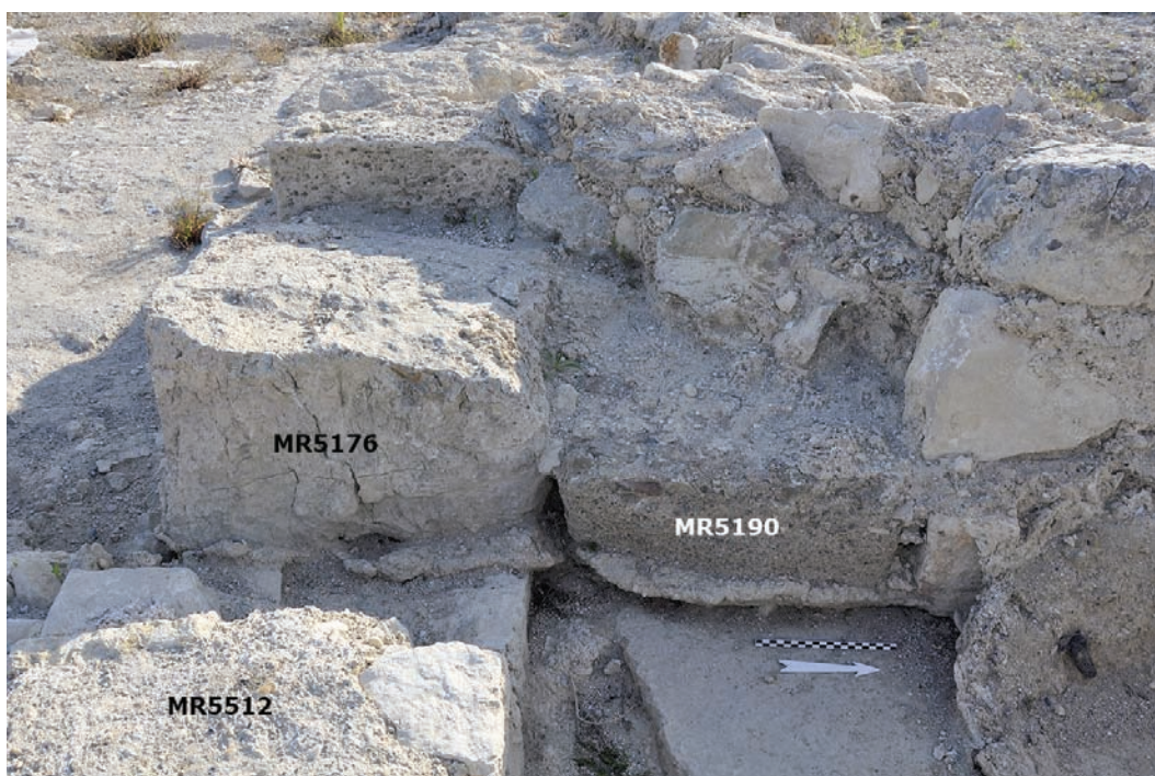
Fig. 6 : Vue depuis l'est de la base de la fondation au niveau de l'angle formé par MR5176 et MR5190 (©V. Mathieu-CNRS)
