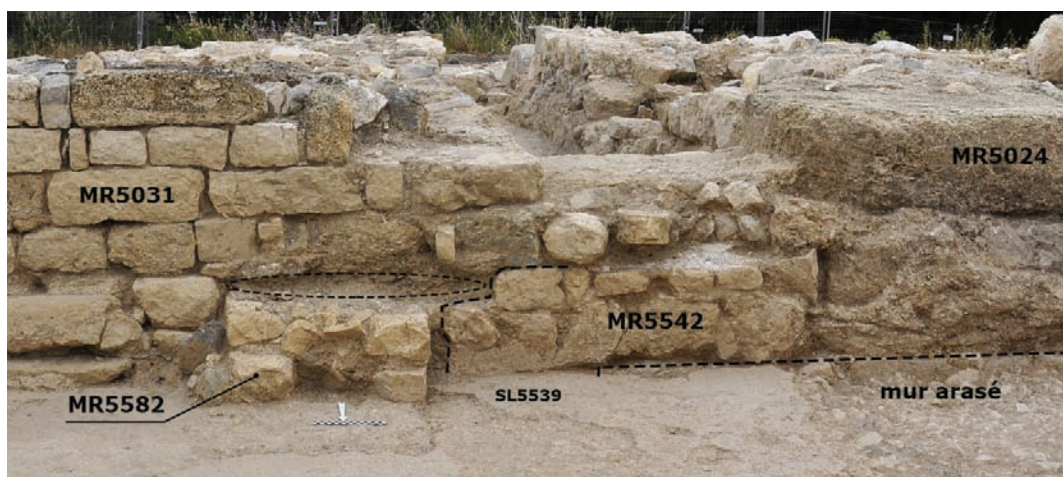
Fig. 15 : Vue du parement nord de MR5542, qui repose sur l'épierrement d'un mur antérieur et sur SL5539 ; il est épierré dans sa partie basse lors de la mise en place de MR5582 (©V. Mathieu-CNRS).
