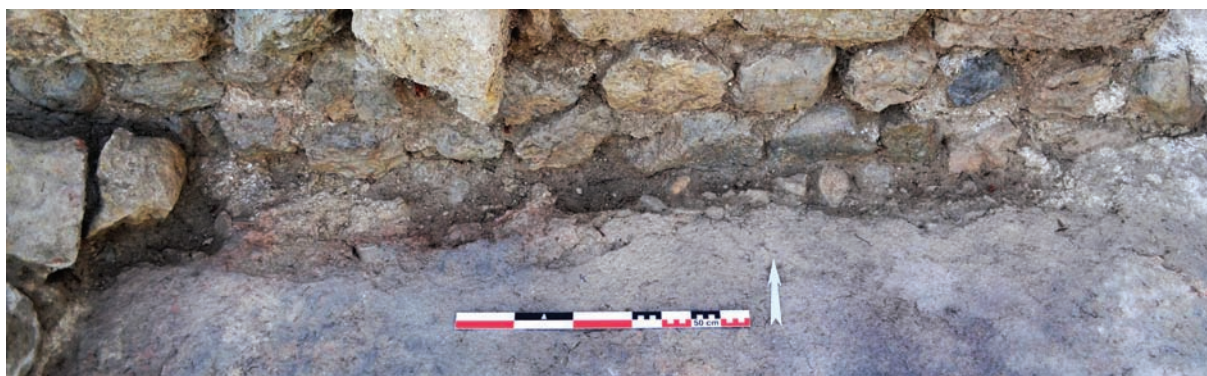
Fig. 4 : vue depuis le sud de la tranchée de fondation TR5502 (Cl. G. Duperron)
