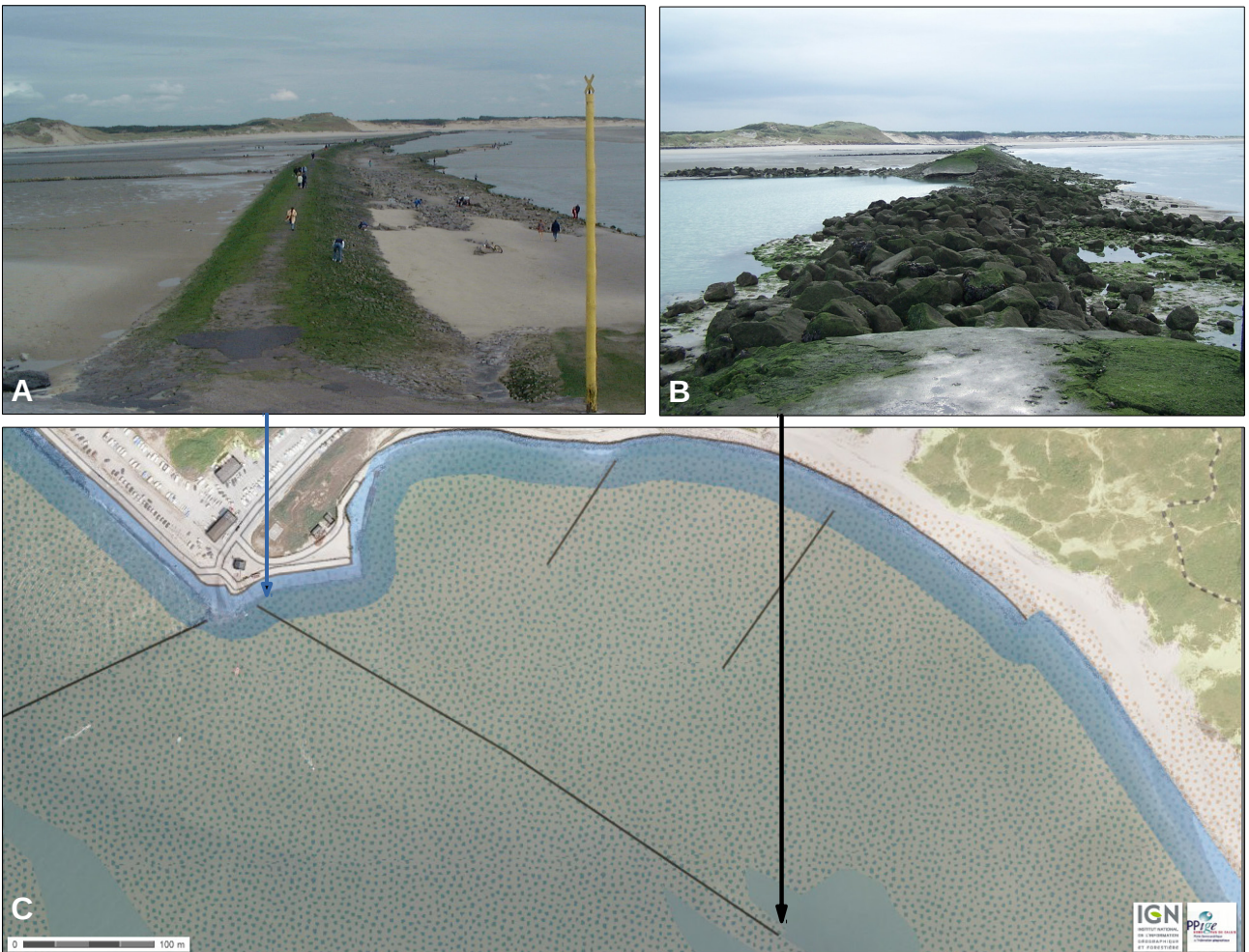
Figure 6.20 : Brèche (B) au niveau de la digue submersible (A) sur la rive nord de l'Authie (C) (A, B : clichés Isabelle Liénard, 2009 ; C : IGN-PPige, geoportail.gouv.fr , 2016)
