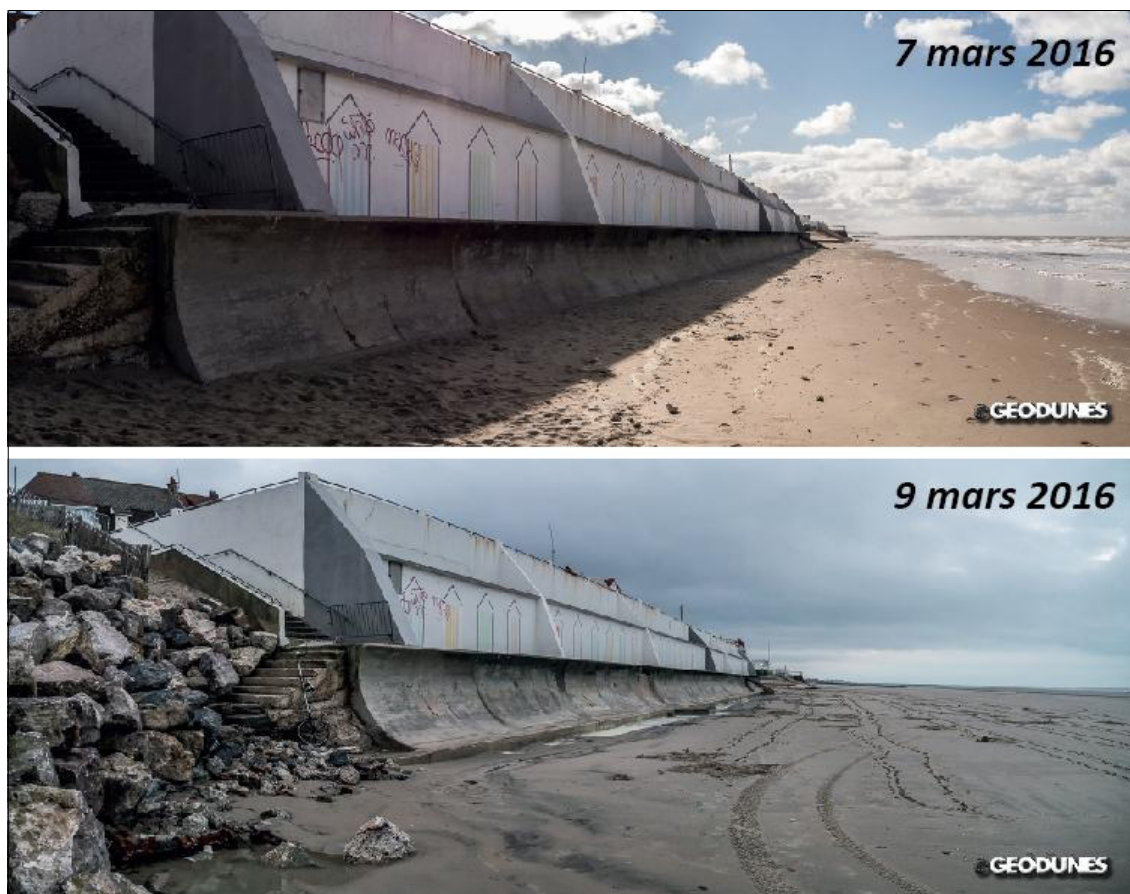
Figure 5.11 : Abaissement de la plage devant le perré de Merlimont en mars 2016 (clichés Adrien Cartier, Géodunes, 2016)
