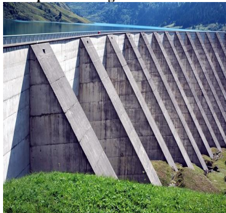
Exemple de barrage de rétention
