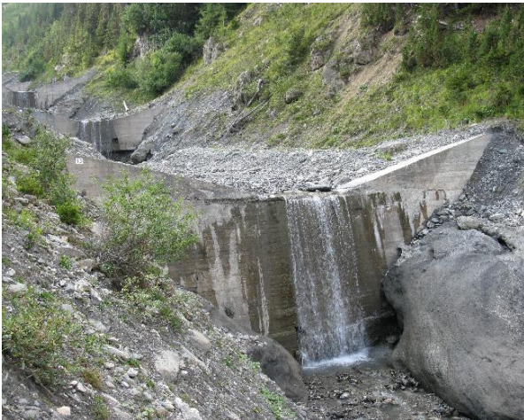
Fig. 1. Barrages de correction torrentiels. Bassin versant de Saint Antoine, France, 2014 (Source : INRAE, Unité de recherche ETNA).
