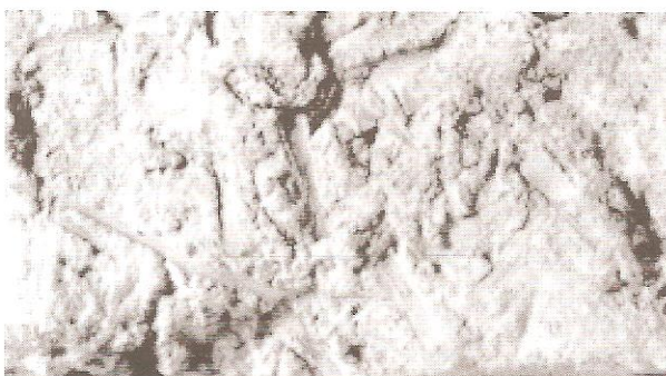
Fig. 4 – Détail d'une brique du rempart romain, mur F. Ici, les brins de paille ont disparu et n'apparaissent que sous la forme de leur empreinte. Photo D. Bagault, C2RMF, J. Menanteau, op. cit.
