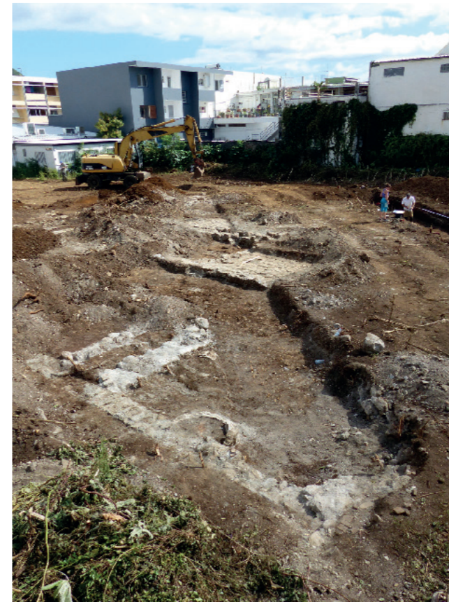
[Fig. 5]: Vue générale du sondage n° 2 depuis le sud-ouest (photo Th. Cornec / Inrap)
