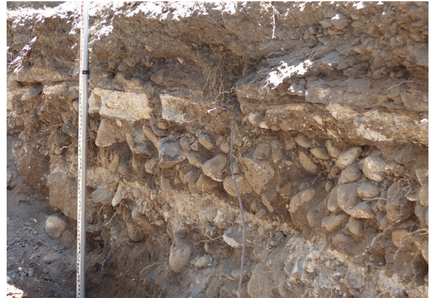
[Fig. 5]: Vue en coupe de 2 sols en mortiers superposés observés dans le sondage n°15 (photo D. Rigal / Inrap)
