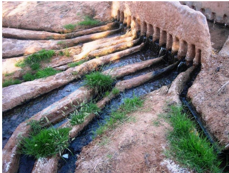
Photo 3.3 : Partiteur ou “peigne”, permettant de répartir le flux d’eau selon les droits d’eau, en Algérie (Cliché : © Molle, in Water Alternative Photo Library)
