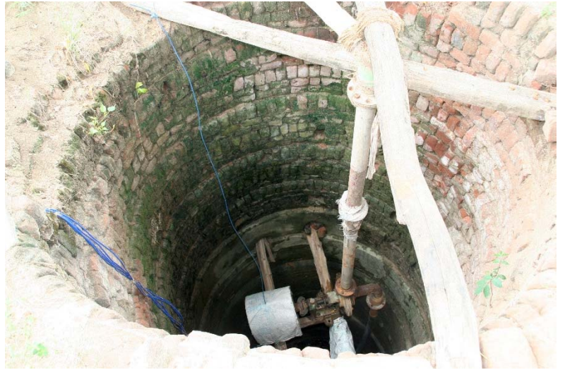
Photo 4.2 : Puits tubé ( well-cum-bore ) avec le moteur positionné au fond du puits
