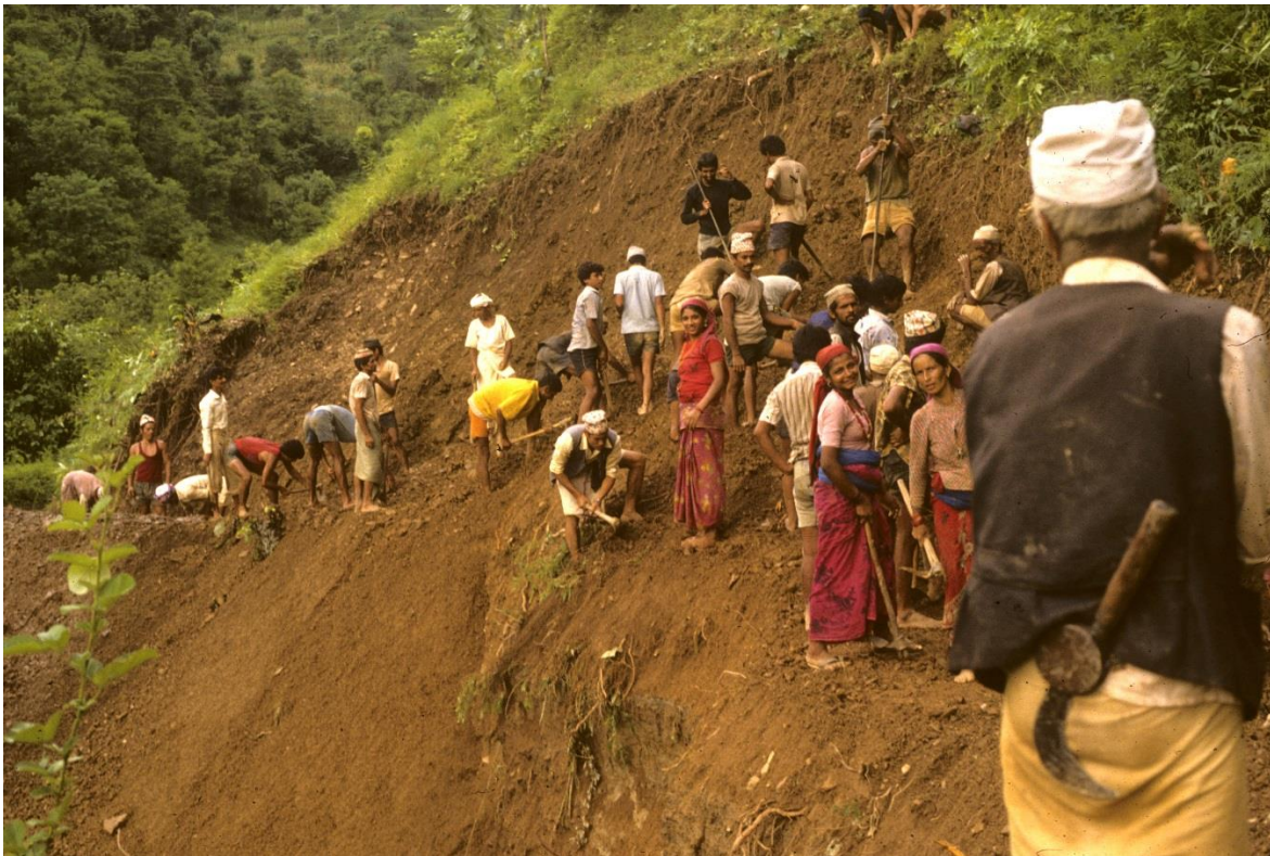
Photo 2.0 : Réparation collective du canal d'Aslewacaur suite à un glissement de terrain ayant emporté une partie de ce dernier (Juillet 1990)
