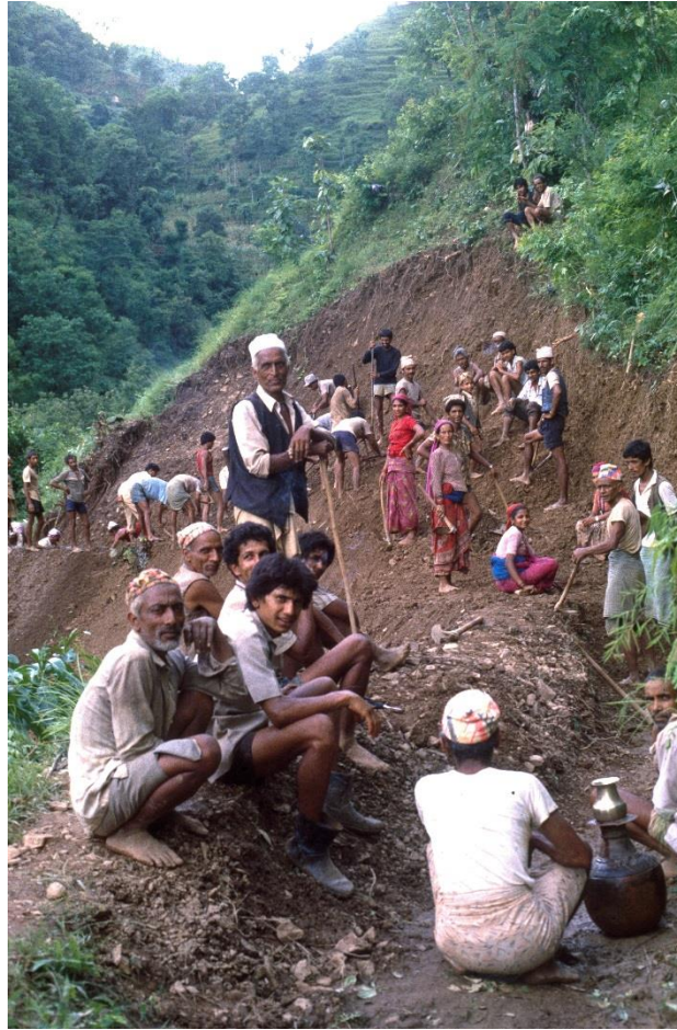
Photo 2.1 : Réparation collective du canal d'Aslewacaur suite à un glissement de terrain ayant emporté une partie de ce dernier. Le chef du canal qui dirige les opérations se tient debout, avec un bâton dans les mains. (Cliché : O. Aubriot. Juillet 1990)
