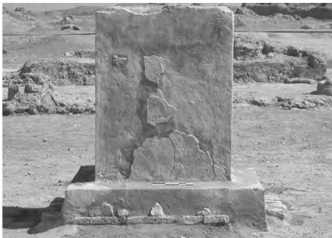
Fig. 12. Doura-Europos, sanctuaire de Bêl. Mise en retrait de la nouvelle maçonnerie lors de la restauration de l'autel nord (avant patinage). Photo M. Gelin, MFSDE.
