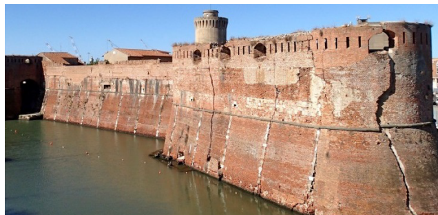
Figura 1: La Fortezza Vecchia di Livorno. Si apprezza una evidente lesione nell'area del Bastione della Capitana.
