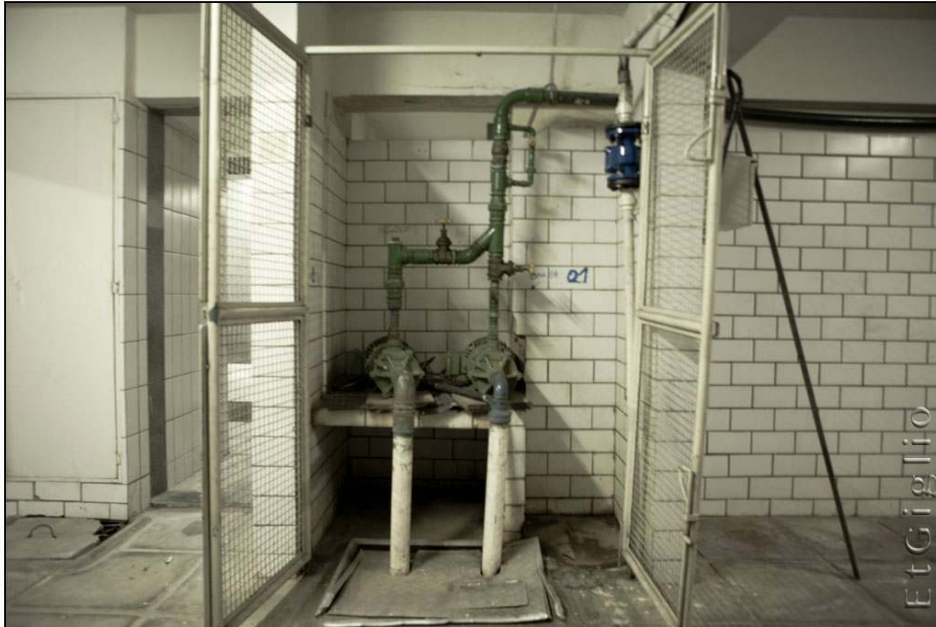
Photo 2. Puits situé dans le garage souterrain d'un immeuble de Boa Viagem
