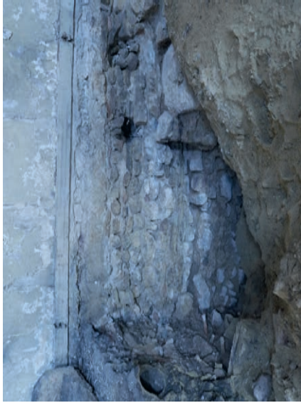
Elevation du mur nord (UM3) en partie basse: installation du mur actuel (période contemporaine) sur des maçonneries anciennes : massif de l'épaulement de l'abside (à droite du cliché)
