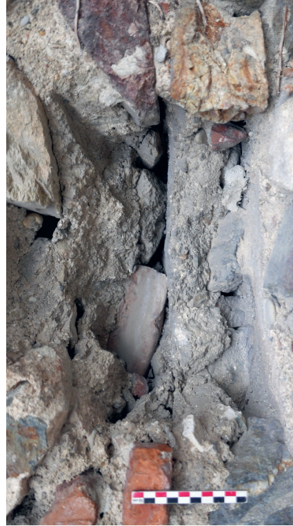
« planées » visible dans la maçonnerie de la deuxième phase dite carolingienne. Le niveau de mortier horizontal visible au centre de la photographie correspond à une phase de travail, peut-être une journée, au sein d'un même chantier de construction.
