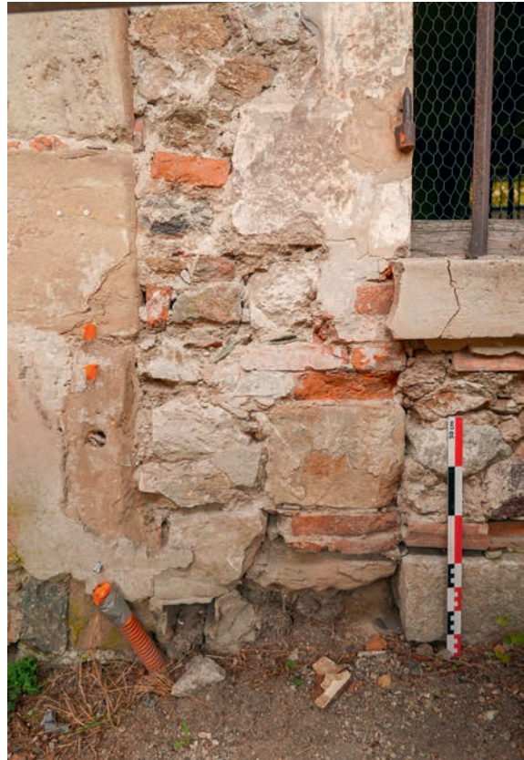
III. 35 : Vue du jambage occidental de la baie B.14 montrant les trois états successifs de gauche à droite : porte-cochère UC 1.2, réduction en porte UC 1.14 et enfin transformation en fenêtre UC 1.15; Cliché : Quentin Rochet
