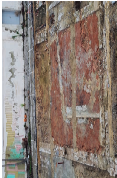
Vestiges de l'aile ouest en secteur 3, sol en carreau de terre cuite, anciennement vernissée
