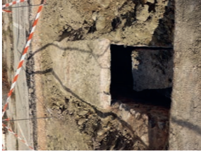
Le collecteur est-ouest en limite d'emprise ouest
