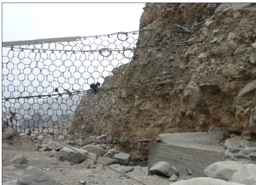
Illustration 15 - Dommages subis par la barrière n° 15 dans le ravin Quirio
