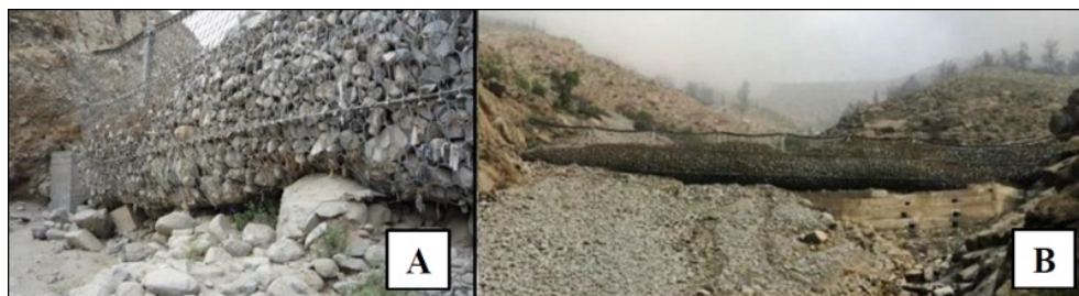
A : Barrière flexible 15 dans le ravin Quirio. B : Barrière flexible 10 dans le ravin Carossio.
