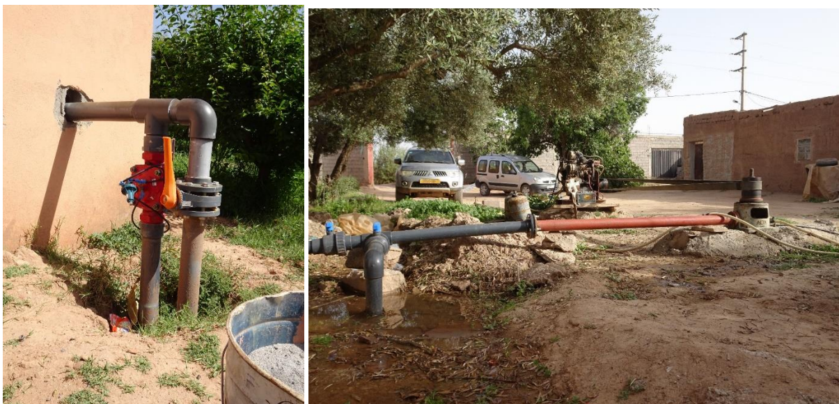
Figure 19. Interconnexion du forage avec le réseau collectif, avec des vannes permettant de choisir la ressource distribuée sur la parcelle
