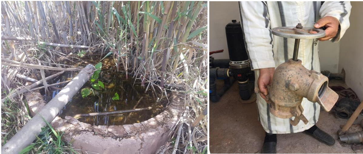
Figure 12. Borne et conduite utilisées pour l'irrigation en gravitaire et remise en service (à gauche) et dispositif utilisé pour brancher les nouvelles installations sur la borne (à droite) (photo prise le 16/04/2019)
