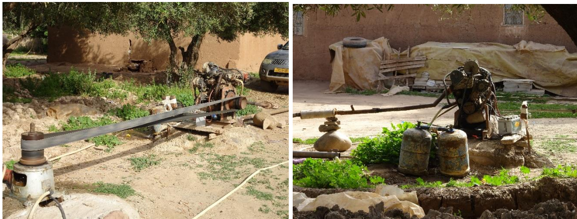
Figure 20. Puits équipé d'une pompe et d'un moteur alimenté par le gaz butane (photos prises le 18/04/2019)
