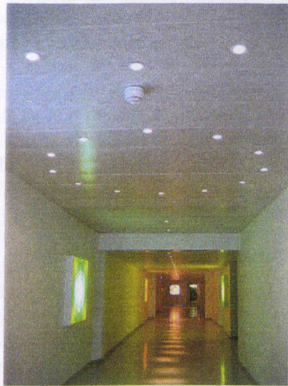
Eclairage en faux-plafond
