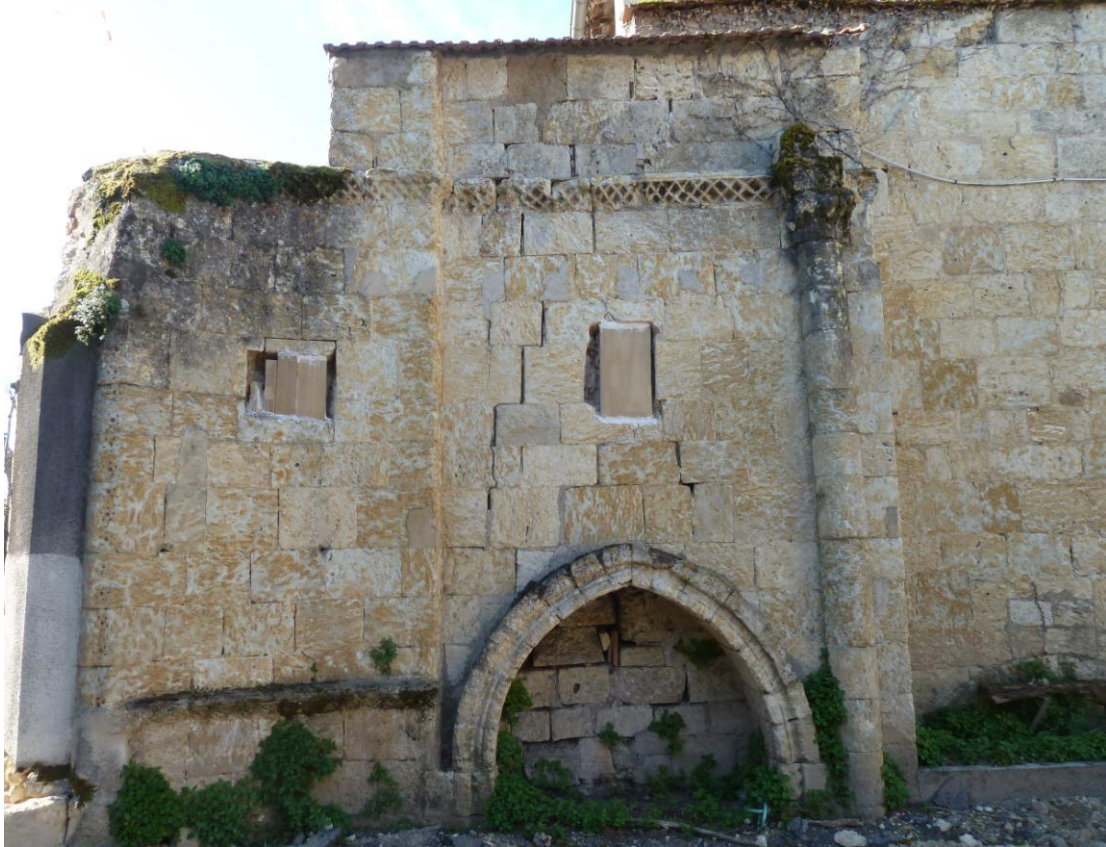
Fig. 26 : Auch, ancien prieuré Saint-Orens, vestiges de l'absidiole du bras sud du transept (Cliché C. Balagna).
