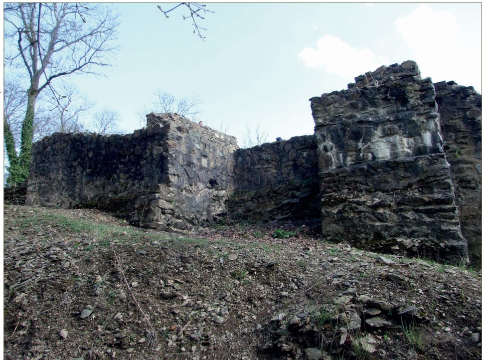
Fig. 2.55 – Élévations nord-ouest. Le contrefort (UC 2.2) de l'enceinte est en premier plan. À l'arrière-plan, la pièce A (UC 3.5).
