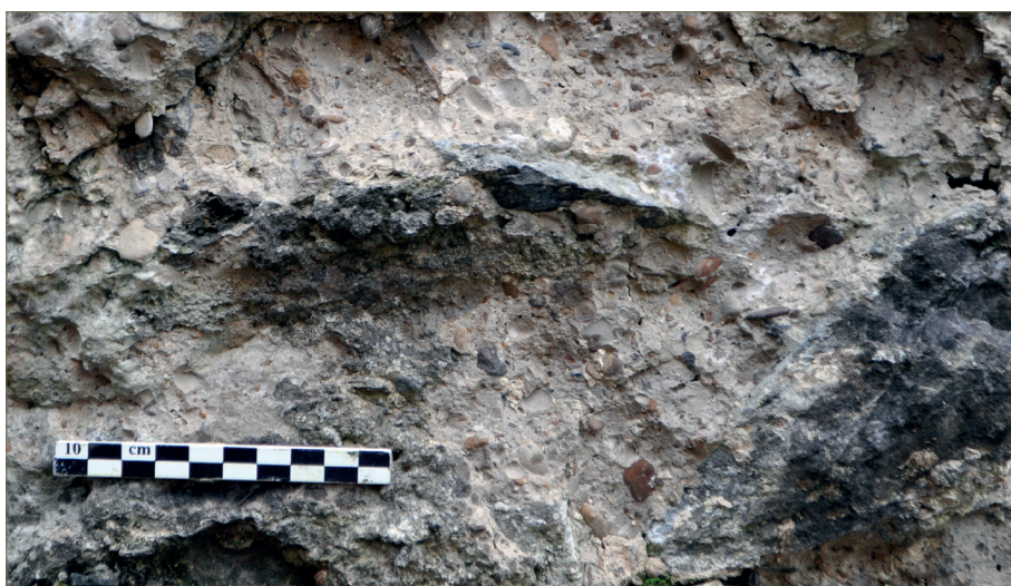
Fig. 2.54 – Élévation intérieure de l'enceinte (UC 2.6), à l'angle avec l'aula. On distingue trois trous de boulins.
