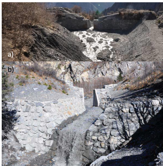
Fig. 5: Structure en 2020 avec des ailes de déversoir, un canal guide revêtu en aval et un contre-barrage : a) vue amont et b) vue aval
