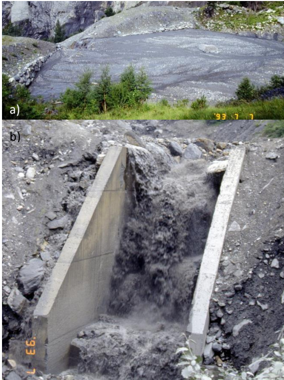
Fig. 3: Lave torrentielle du 7 juillet 1993 : a) vue de la plage de dépôt remplie depuis l'amont et b) vue en aval de la fente bloquée par les blocs rocheux. Notez les preuves de débordement et l'érosion marginale qui en découle.
