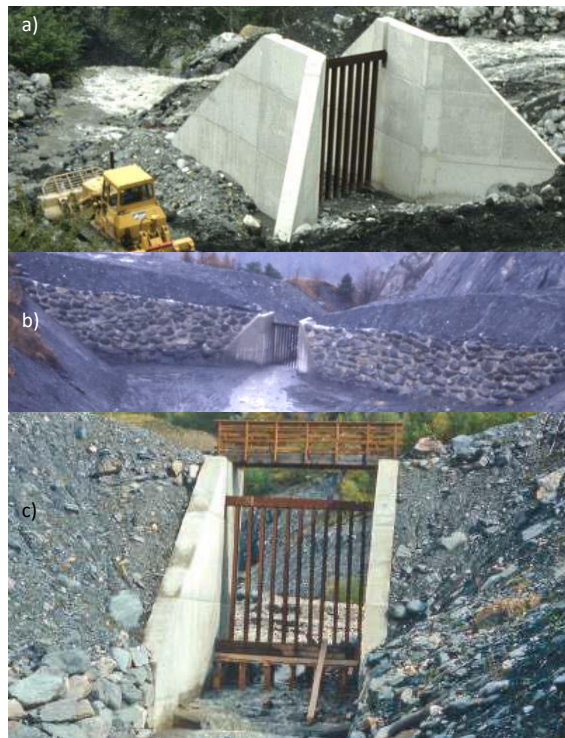
Fig. 2: Le barrage à fente supérieur dans sa première conception : a) vue amont de la structure à fente en 1986 ; b) vue amont de la fente et des digues latérales protégées par des enrochements coulés en 1987 ; c) vue aval en 1989 avec zoom sur la fente et la grille. Noter que la face aval des digues n'était pas protégée à l'époque contre l'érosion lors des surverses par-dessus l'ouvrage.
