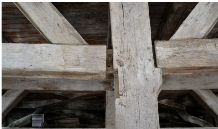
Fig. 5 : Rupture de chevilles dans un assemblage tenon-mortaise
