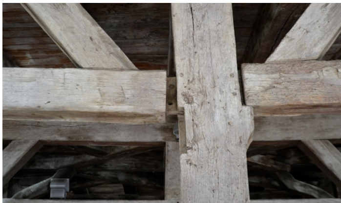
Fig. 5 : Rupture de chevilles dans un assemblage tenon-mortaise
