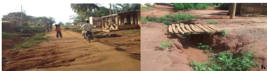
Figure 3. Incisions sur une rue à Zogba (a) et une ravine à Houen-Hounso (b) mise en place par l'érosion. (Prise de vue : Zoglobossou, mai 2013)
