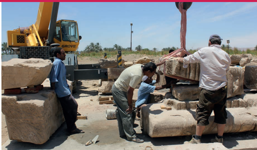
Figure 8. Un chantier de remontage à Médamoud. L'installation d'un bloc nécessite deux opérateurs : le grutier assure le déplacement du bloc dans l'espace, tandis que le tailleur de pierre, posté devant le lieu de pose, agit manuellement sur sa rotation et son éventuelle inclinaison.
