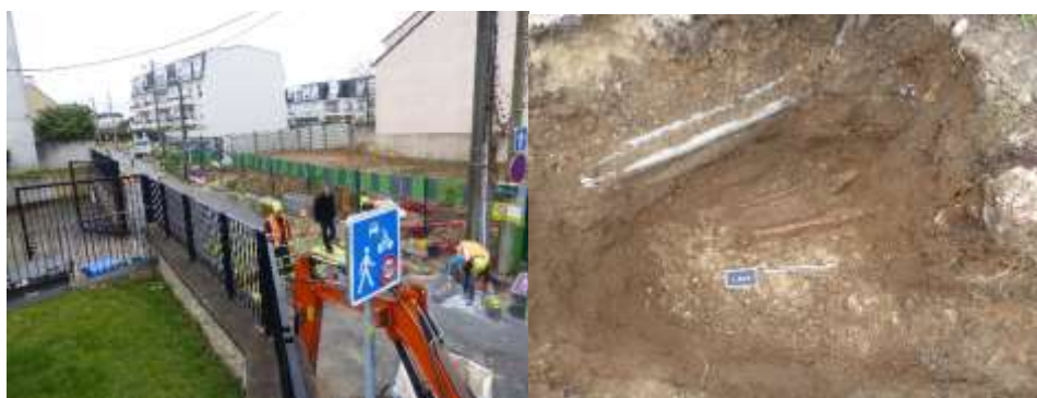
FIGURE 10 : SUIVI DE TRAVAUX DE VOIRIE EN BORDURE DES EMPRISES DE FOUILLES PRECEDENTES (C. LE FORESTIER, INRAP)
